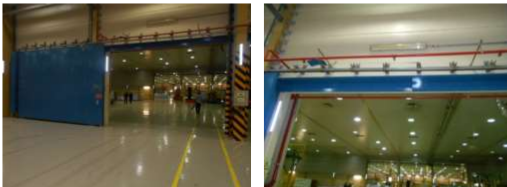
Figura 6.1 – Porta corta-fogo com sprinklers; Pormenor dos sprinklers da porta corta-fogo
