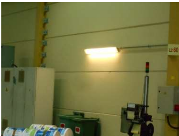
Figura 6.3 – Iluminação de emergência
