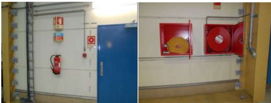
Figura 6.5 – Extintor; Boca de incêndio do tipo carretel e do tipo teatro
