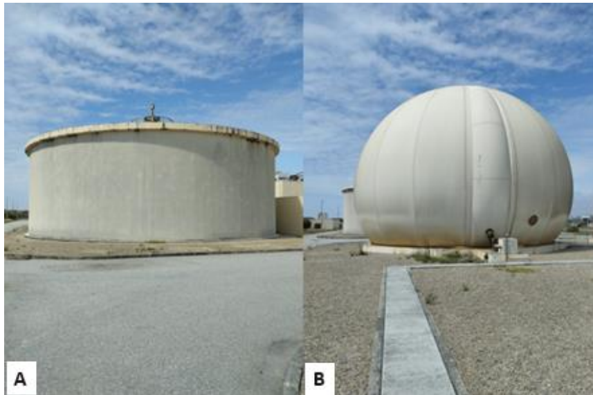
Figura 27 – (A) Digestor; (B) Gasómetro
