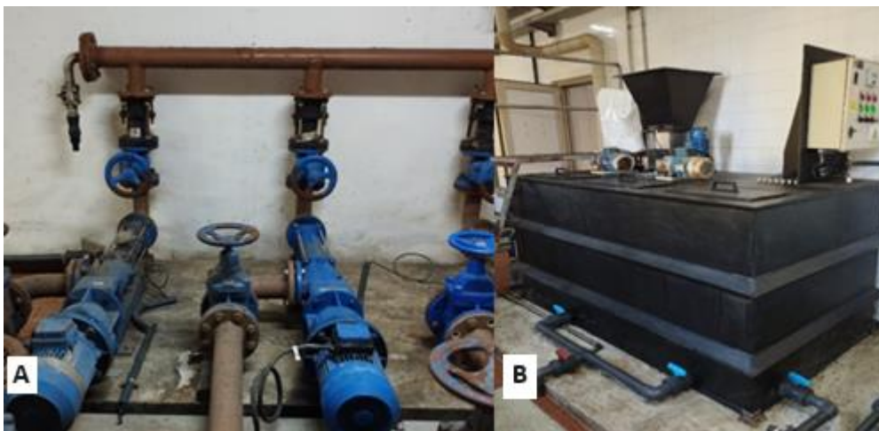
Figura 28 - (A) Bomba parafuso lamas digeridas; (B) Unidade de preparação de polímero
