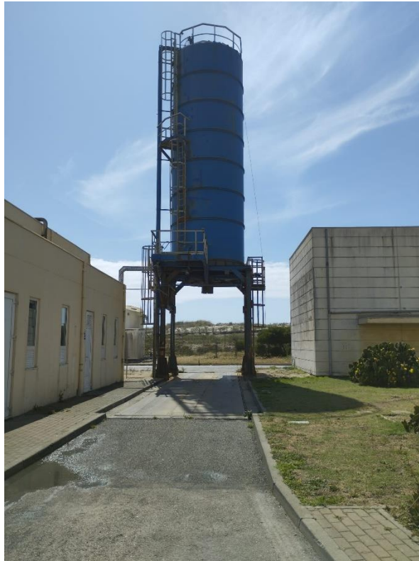
Figura 30 - Silo de armazenamento das lamas
