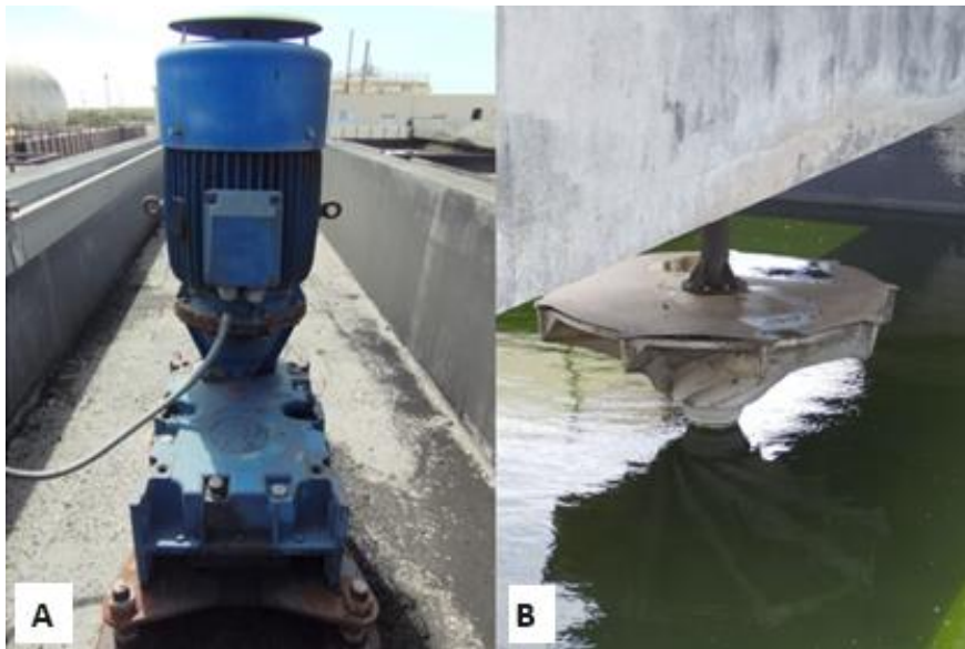
Figura 23 – (A) Motorreductor; (B) Turbina de arejamento
