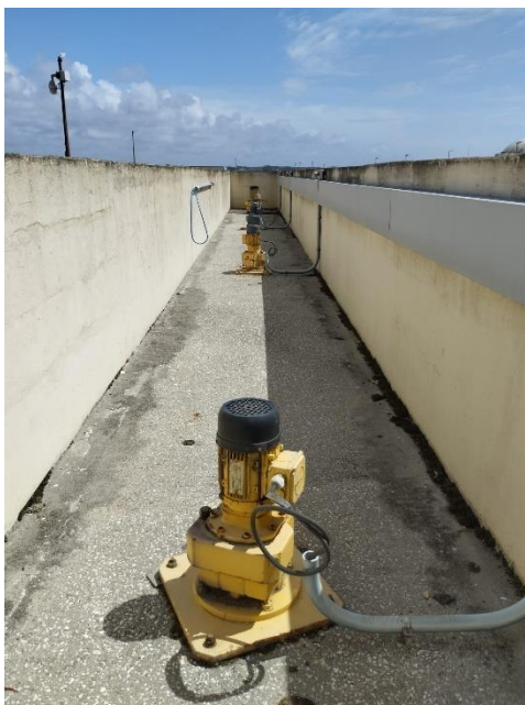
Figura 21 - Agitadores de mistura de cloreto férrico
