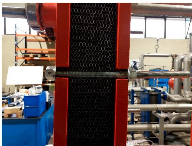
Figura 5.5 — Falha da Estrutura de Suporte DN 65.
