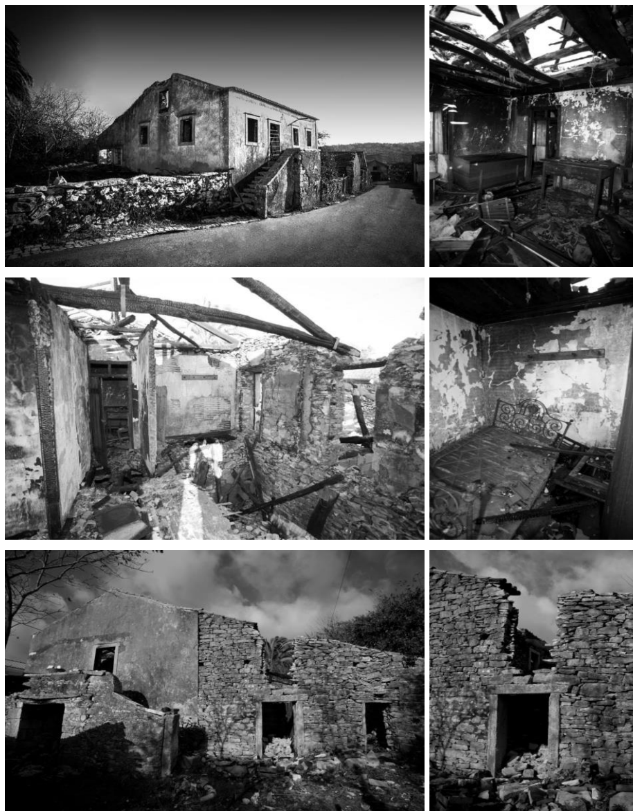
Figura A12 – Estado do edifício após o incêndio referido
