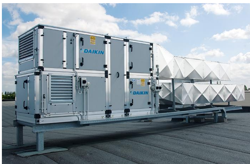
Figura 6- Unidade de Tratamento de Ar (Daikin, 2024)
