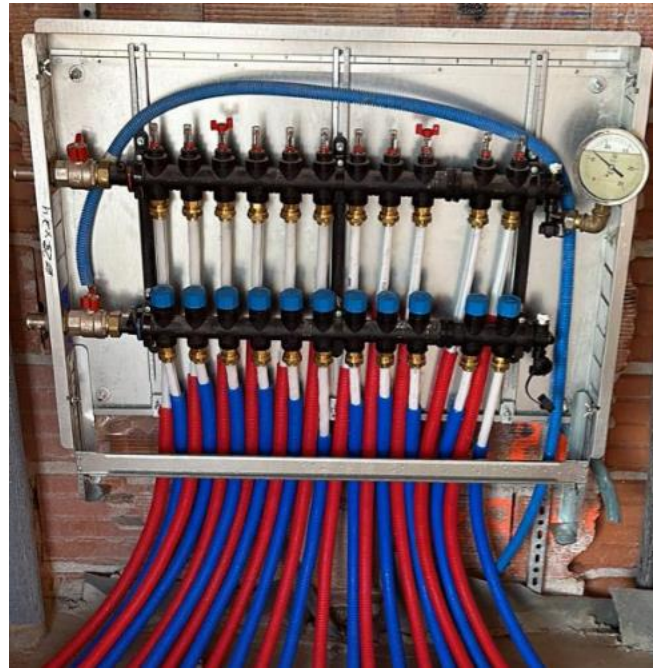
Figura 72 - Caixa de coletores e respetivas ligações
