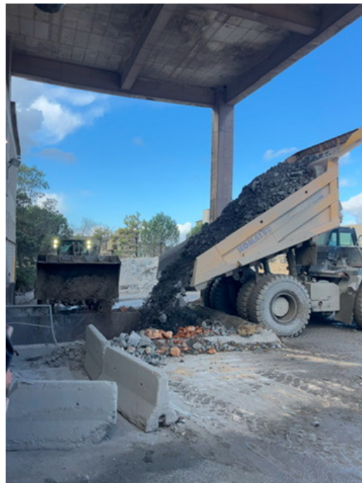
Figura 3.9 Descarga de Matéria-Prima no Britador
