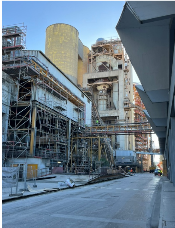
Figura 3.12 Torre de Ciclones
