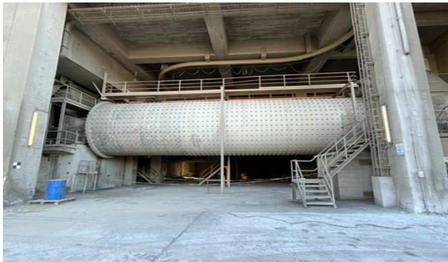
Figura 3.14 Moinho de Bolas de Cimento
