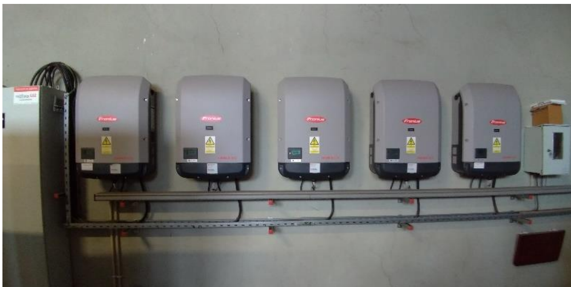
Figura 2.4 – Inversores “FRONIUS” de 25kW cada.
