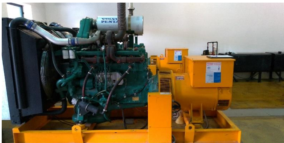
Figura 5.14 – Grupo de Emergência da marca "Leroy-Somer" de 400kVA.
