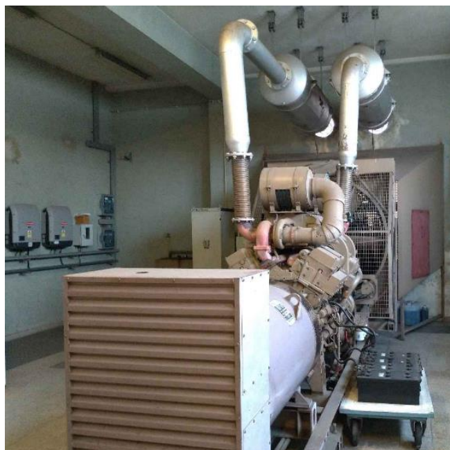
Figura 5.9 – Primeiro grupo de emergência do C.H.U.C.,HU Coimbra (gerador).
