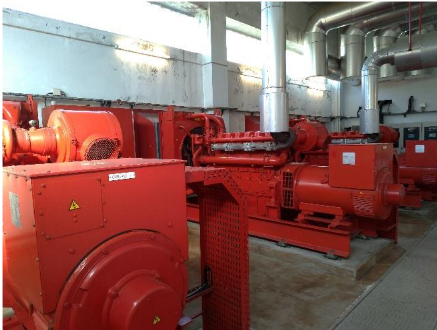
Figura 5.11 – Grupo de geradores de emergência.
