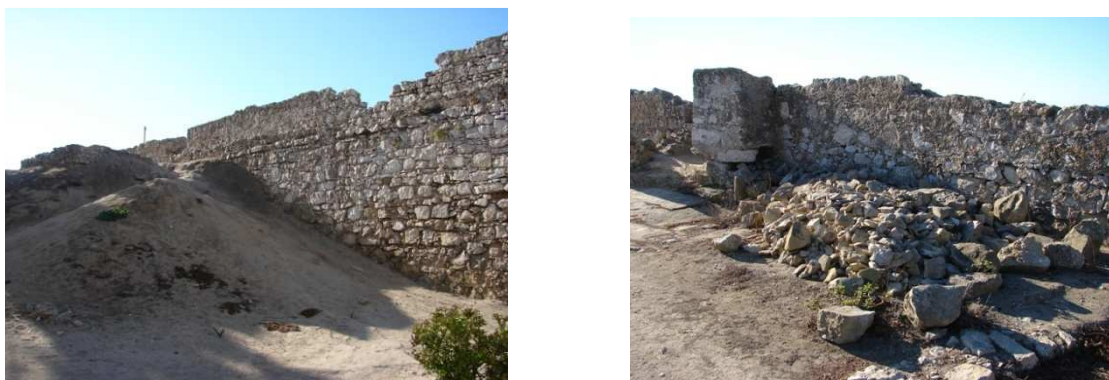
Figura 12 – Meio-baluarte de S. Vicente, com evidentes sinais de degradação e sem acesso ao respectivo topo e caminho de ronda.
