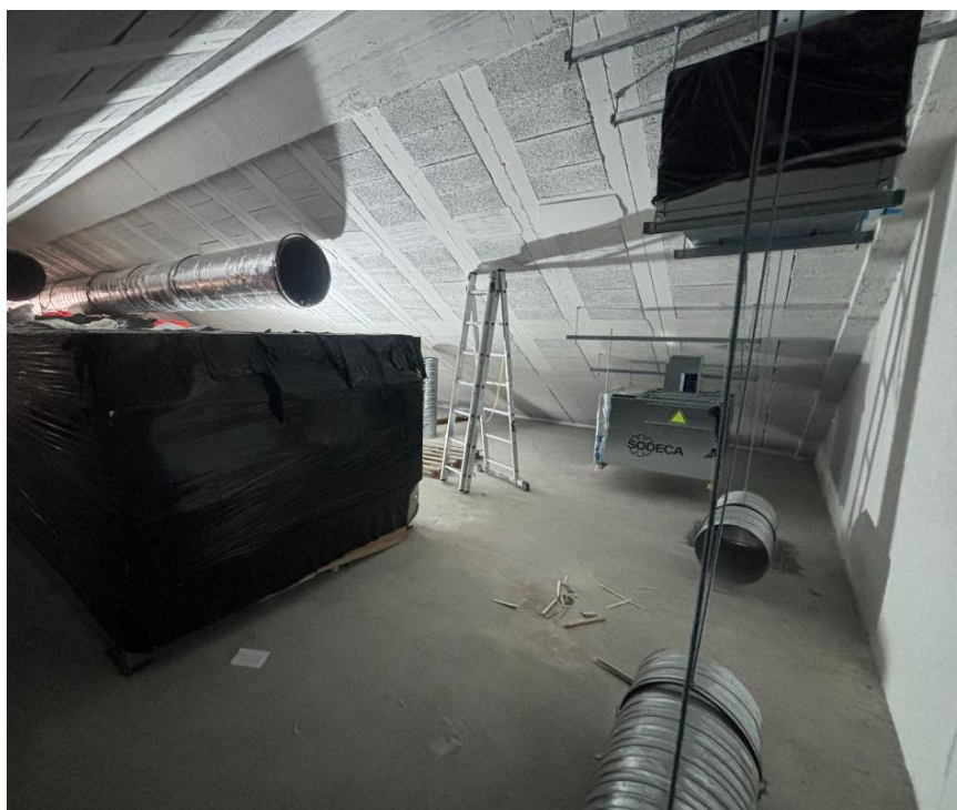
Figura 4.21 - Área técnica interior do piso 1 do restaurante
