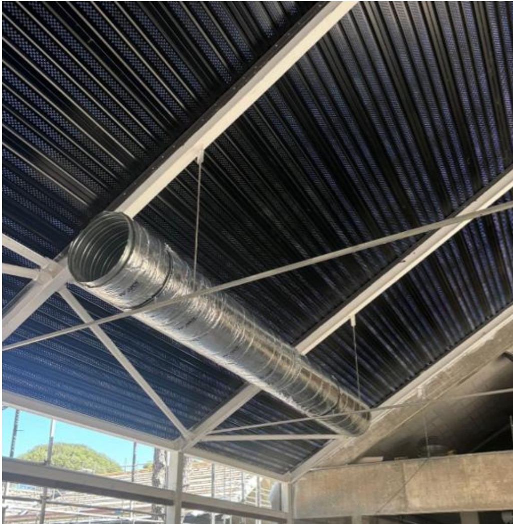
Figura 4.24 - Conduta apoiada nos suportes da cobertura do restaurante na zona de refeição
