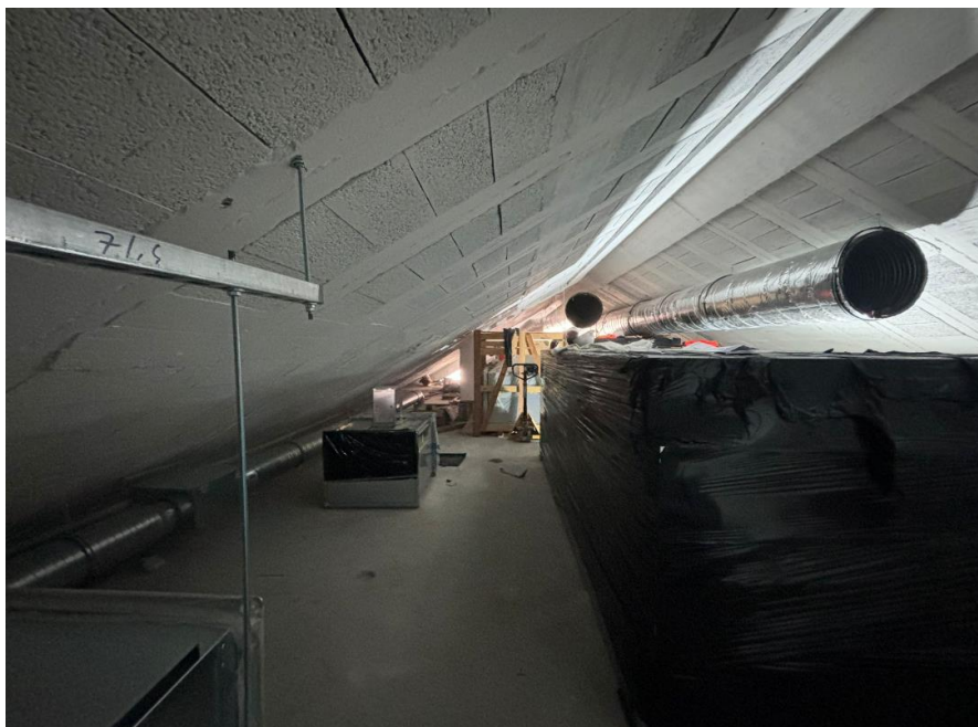
Figura 4.20 - Área técnica interior do piso 1 do restaurante
