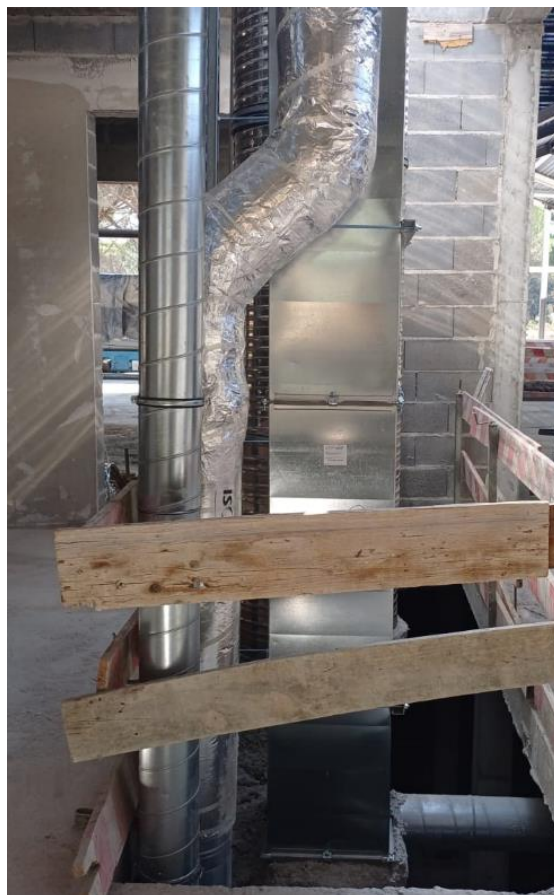
Figura 4.22 - Conduta instalada na vertical na courette entre diferentes pisos
