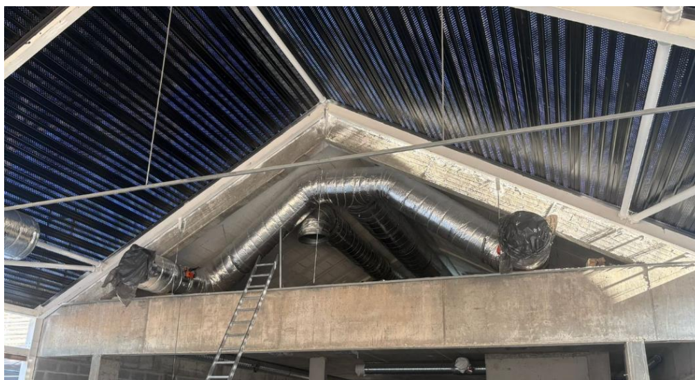
Figura 4.23 - Conduta instalada com a inclinação do telhado à saída da área técnica interior do piso 1 do restaurante
