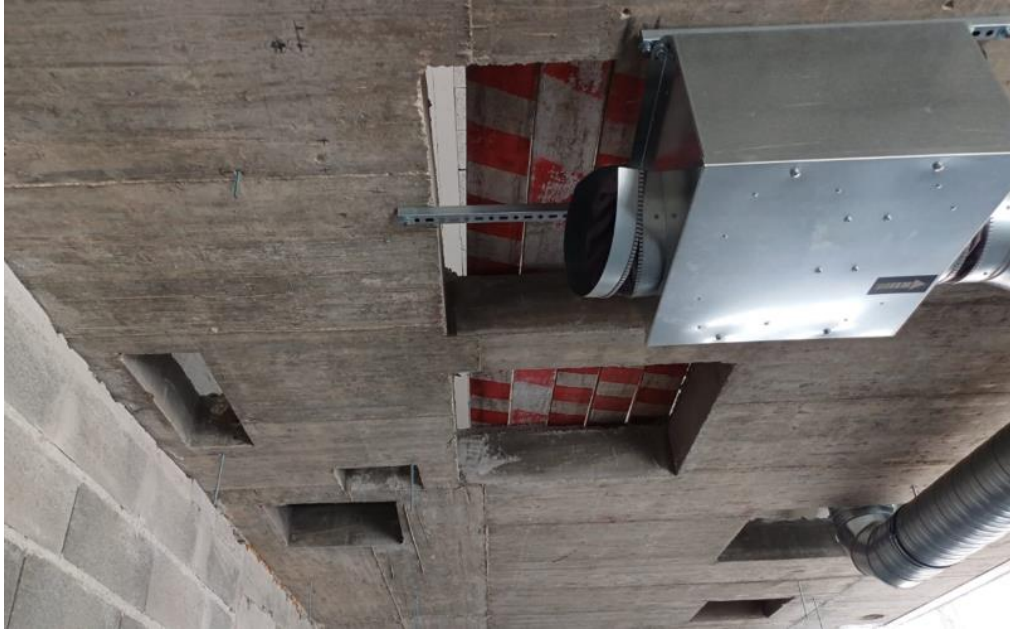
Figura 4.14 - Conflito entre instalação da rede aerólica e os negativos na laje da zona do restaurante
