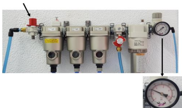
Figura 3.5 – Linha ar comprimido.
