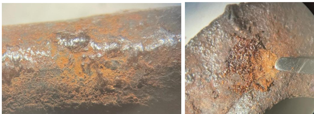
Fig.121 Produtos de corrosão dos parafusos de armar e anilhas. © Juliana Novaes.
