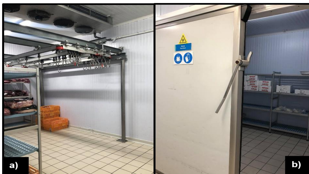
Figura 5 - Câmaras de armazenamento
