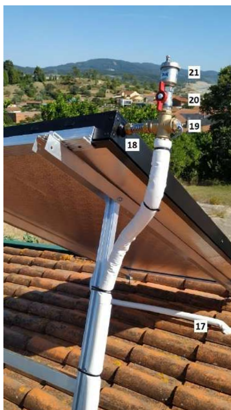
Figura 4.42 - Coletor solar da instalação.
