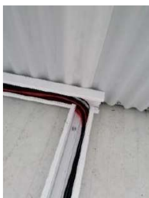
Figura 5.152 - Caminho de cabos não perfurados, em calha PVC 110x50mm.
