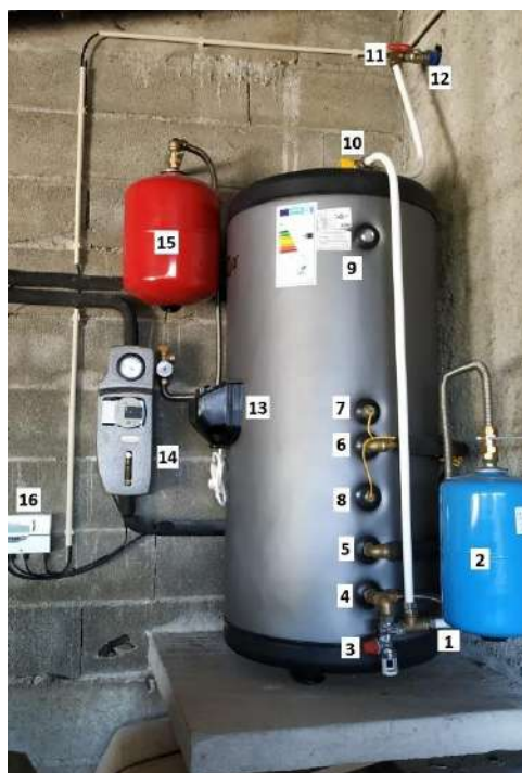
Figura 4.41 - Zona técnica da instalação.
