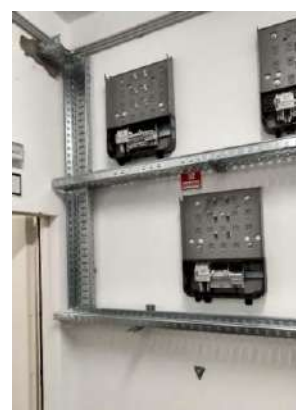
Figura 5.153 – Caminho de cabos perfurados, em esteira perfurada 35x200mm.
