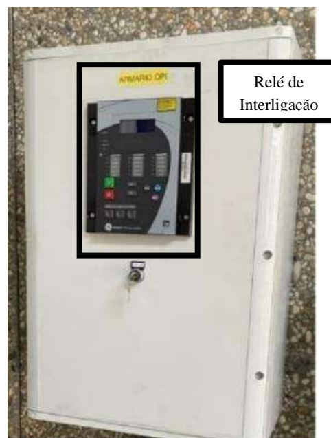
Figura 5.168 - Quadro de Proteção de Interligação, com Relé da marca GE Multilin F650.
