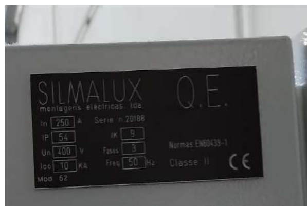
Figura 5.115 - Características elétricas do quadro AC do cliente.
