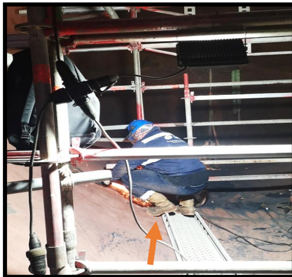
Figura 22 - Rebarbagem de soldadura (postura incorreta)
