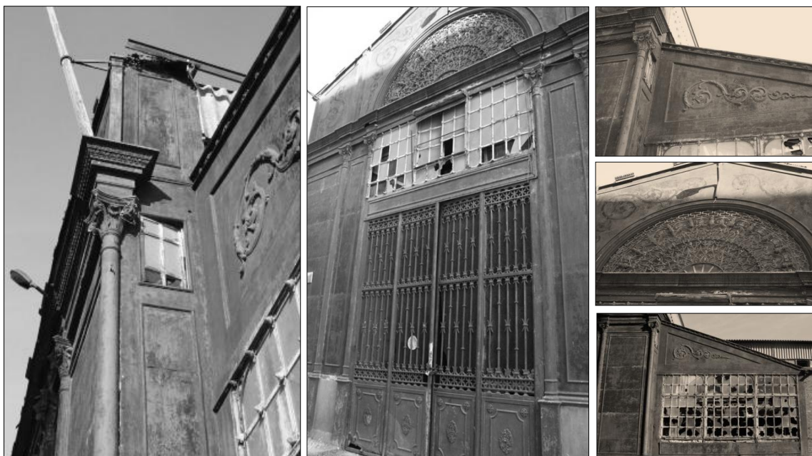
Ilustração 29/ Destaque de elementos arquitectónicos existentes no Pavilhão Oitocentista da Antiga Fábrica da Tabaqueira em Braço de Prata Marvila, Imagens próprias tiradas no local
