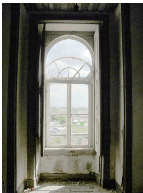
Figura 136. Eflorescências no reboco interior da fachada do lado Norte, no piso 1.
