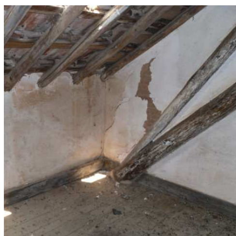
Figura 133. Humidade de precipitação nas paredes divisórias do sótão.
