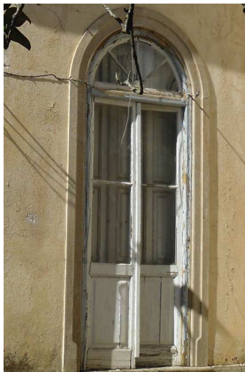
Figura 164. Empenos e deficiências de funcionamento da janela da sacada e fractura dos vidros.
