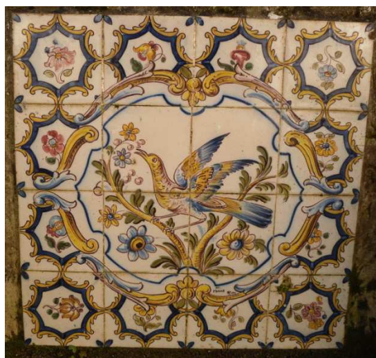
Figura 160. Degradação dos azulejos dos painéis.
