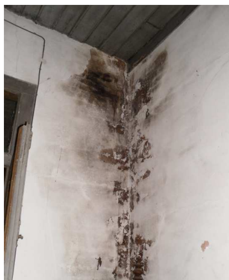
Figura 132. Humidade de precipitação nas paredes divisórias do sótão.
