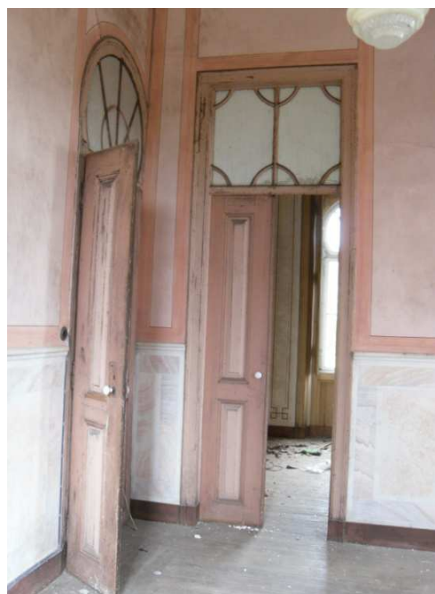
Figura 165. Apodrecimento da madeira e deterioração da pintura das portas interiores.
