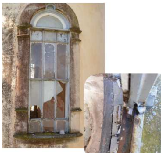
Figura 162. Deterioração geral da janela em ferro.
