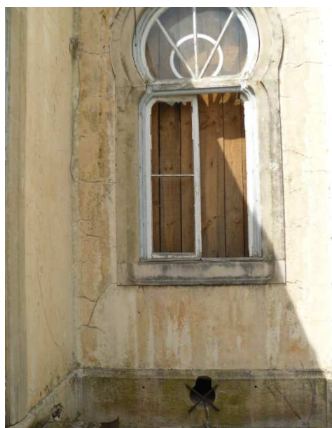
Figura 139. Fissuração, destacamento do reboco tradicional nas fachadas exteriores.
