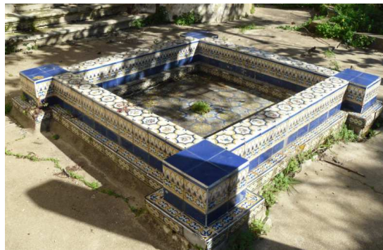
Figura 159. Degradação dos azulejos do lago.
