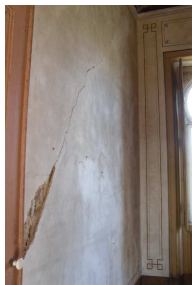
Figura 128. Fissuração e fendilhação nas paredes divisórias do 1º piso.
