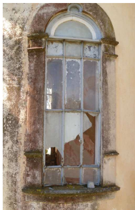
Figura 144. Lascamento, alteração da pedra das cantarias e colonização biológica.
