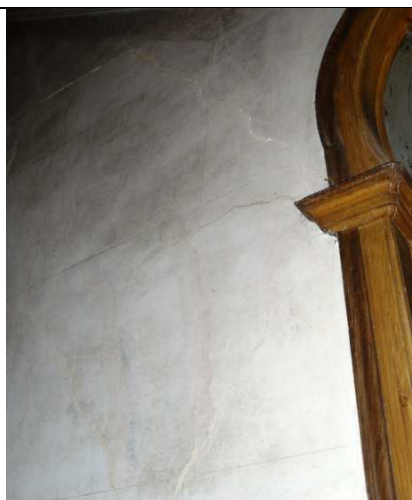
Figura 130. Fissuração e fendilhação nas paredes divisórias do rés-do-chão.
