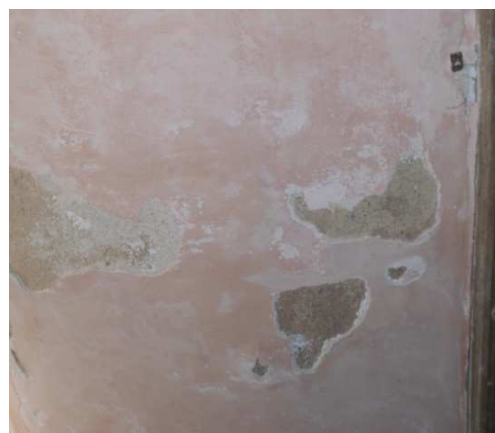
Figura 137. Eflorescências no reboco interior da fachada do lado Sul, no rés-do-chão.
