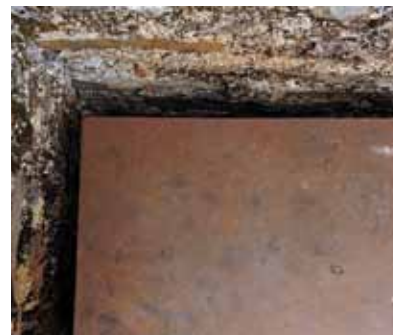
Pavimento desligado da antiga estrutura.
