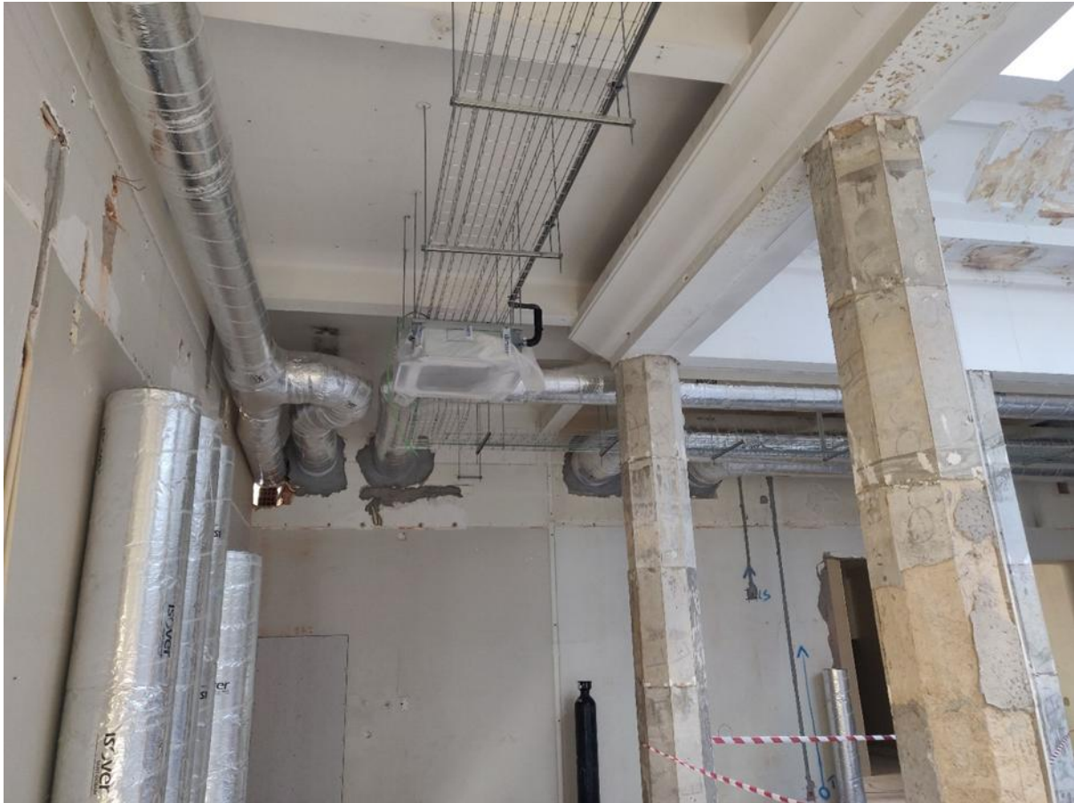
Figura 4.3 – Exemplo de passagem de condutas através de parede no edifício TUMO Coimbra
