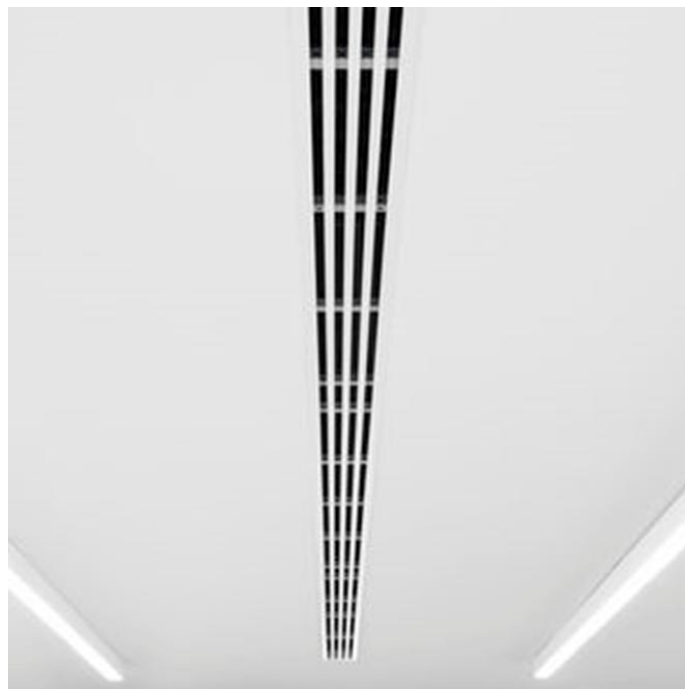
Figura 3.32 - Exemplo de difusor linear instalado
