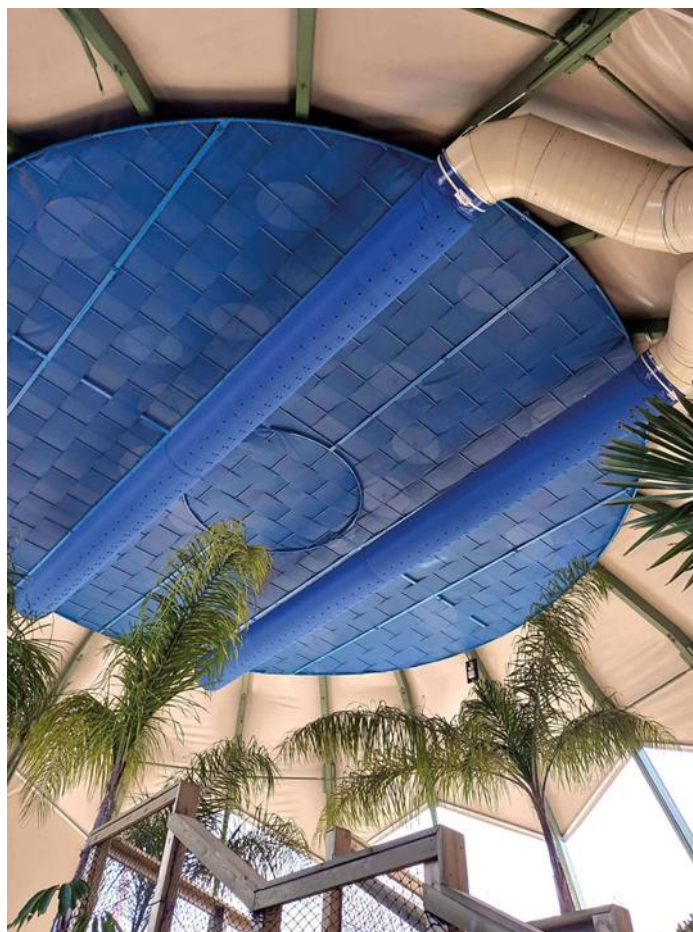
Figura 3.23 – Exemplo de aplicação de condutas têxteis (France Air, 2026)
