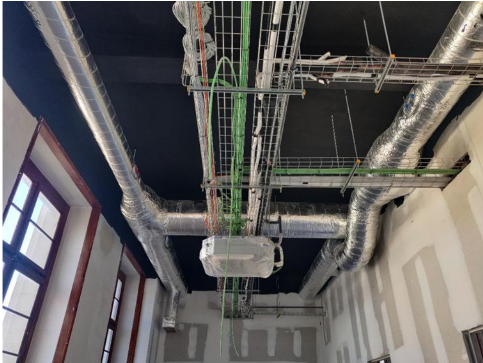
Figura 3.24 - Condutas com aplicação de isolamento térmico
