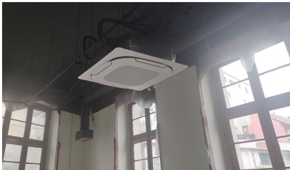
Figura 3.14 - Unidade interior do tipo cassette
