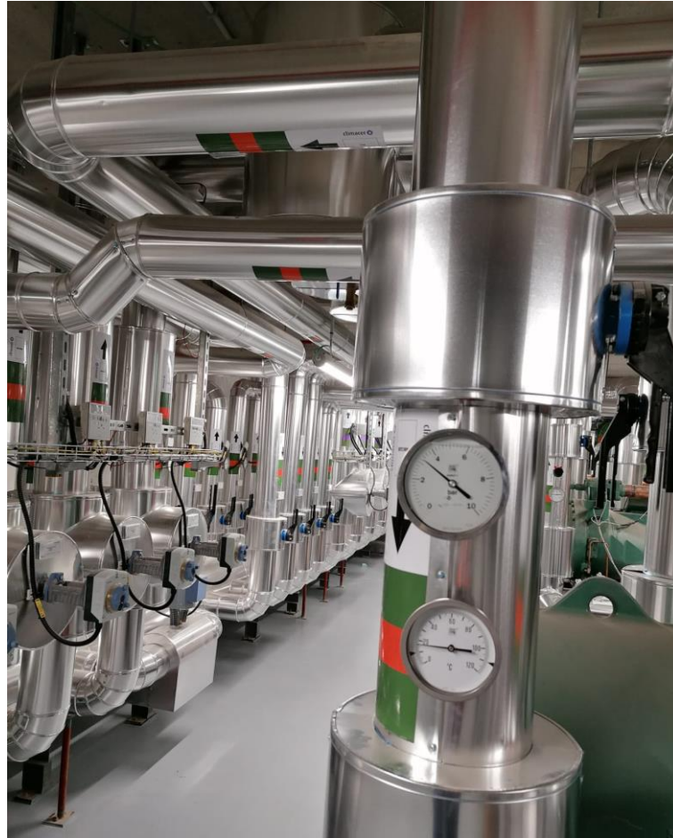
Figura 2.6 - Central Técnica dos Chillers
