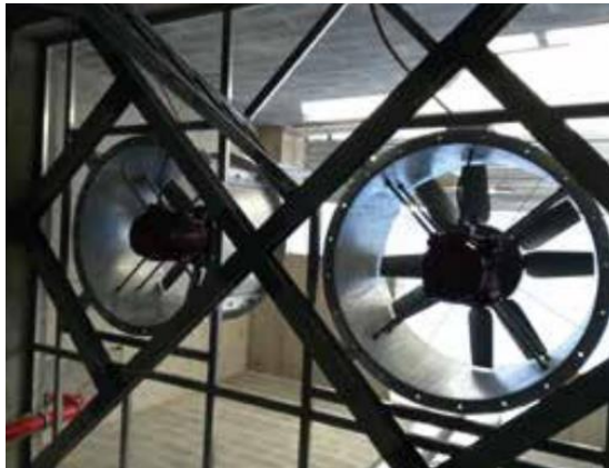
Figura 2.3 - Ventiladores de Desenfumagem da Barragem do Tua
