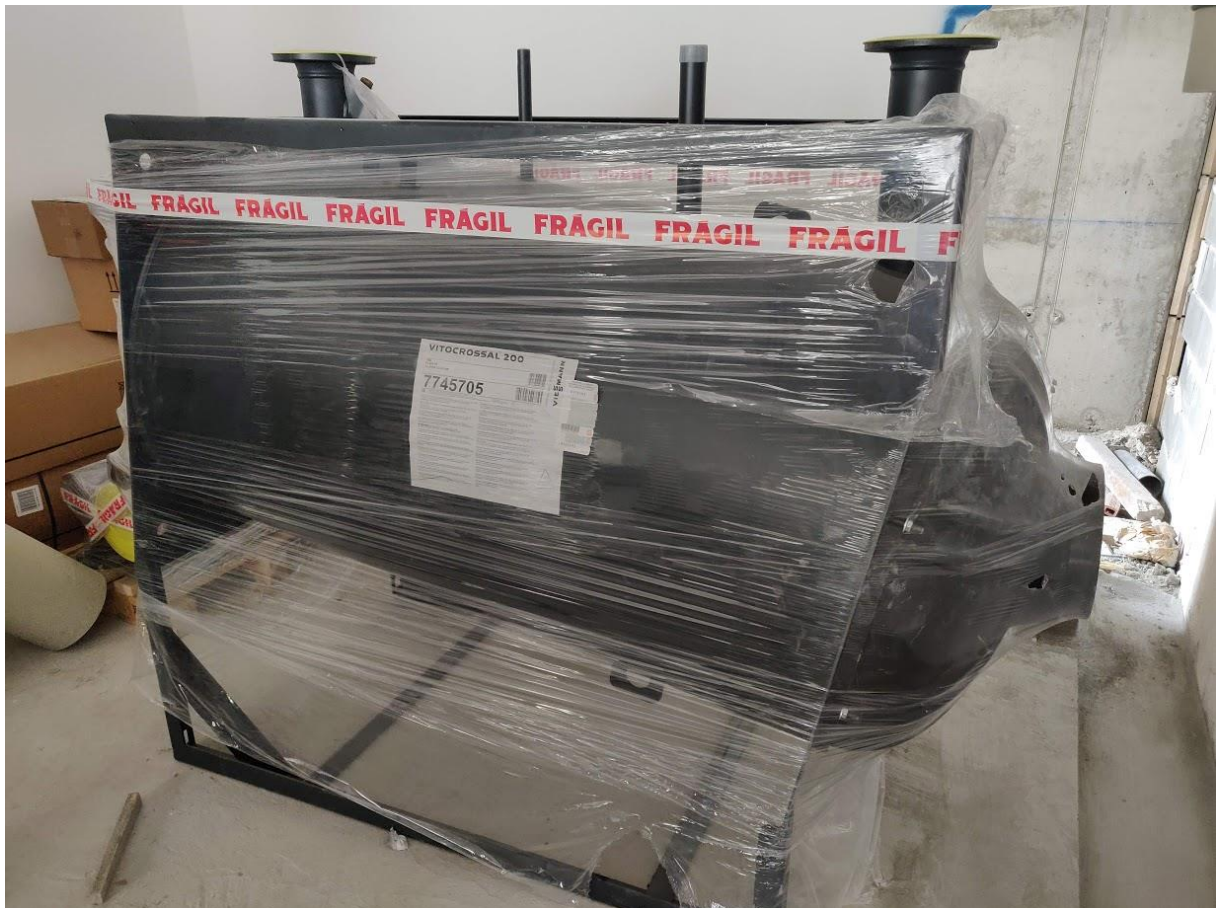
Figura 5.19. Corpo principal das caldeiras do HCT
