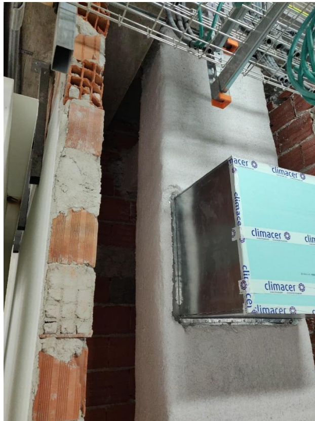
Figura 5.8. Prumada de conduta projetada com Dossolan HCT
