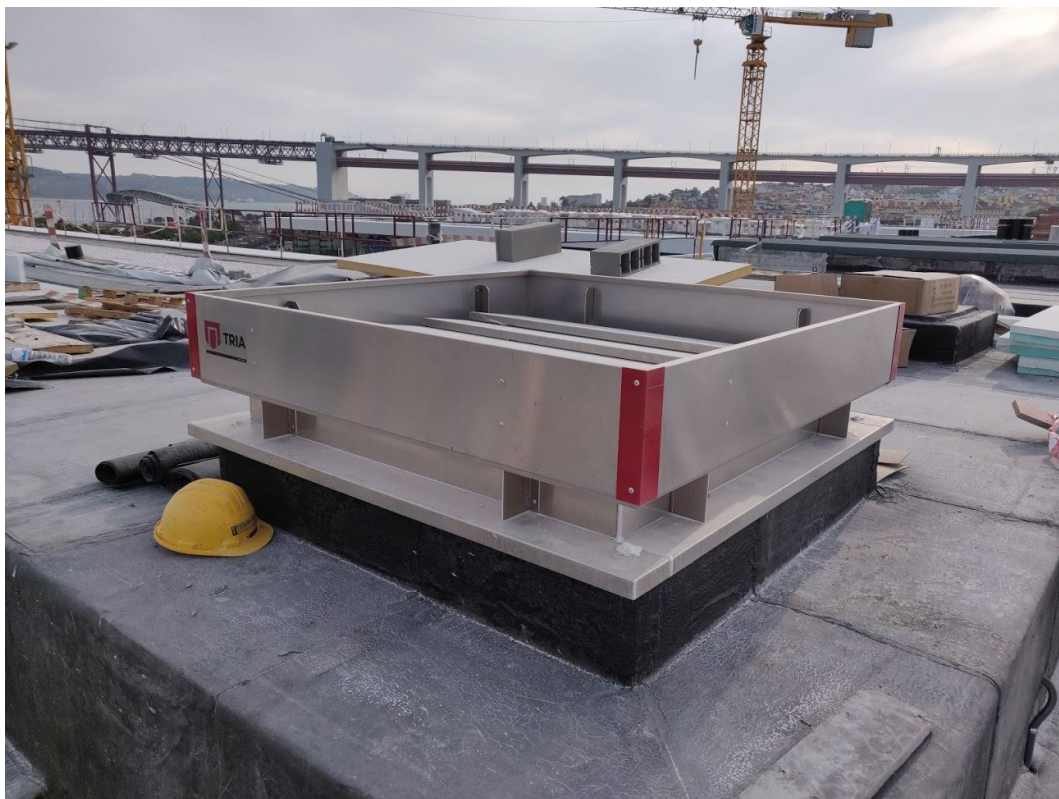
Figura 4.6. Exutor de desenfumagem instalado na cobertura do HCT
