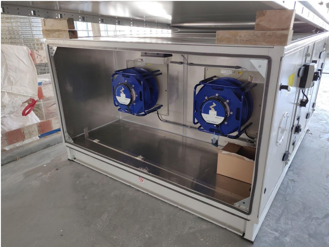
Figura 5.15. Ventiladores de uma UTA do HCT
