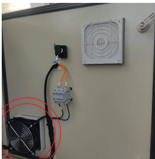
Figura 95 - Parte traseira da porta de acesso
