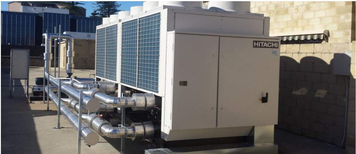
Figura 35 - A atualização de um "Chiller" industrial para uso de um gás refrigerante que cumpra as atuais normas ambientais e de eficiência consiste num serviço de retrofitting, onde se inclui a remoção, armazenamento e reciclagem do gás antigo e em certos casos substituição de tubagem e filtros. (HITACHI, 2021)
