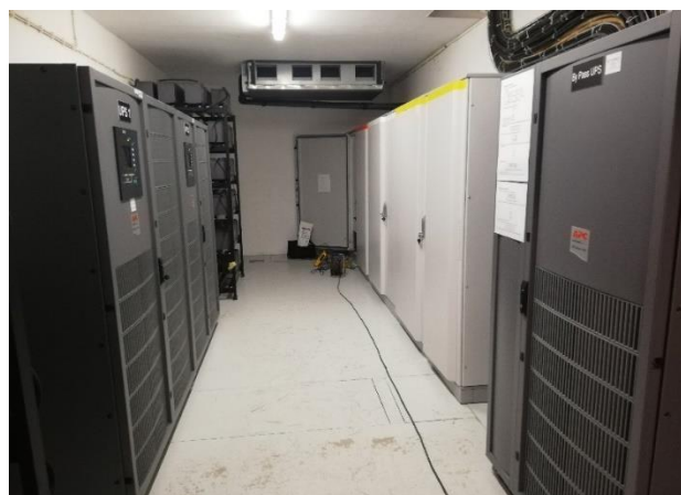
Figura 3.6-Sala do quadro geral
