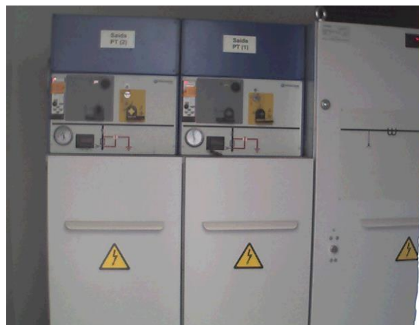
Figura 3.2-Aparelhagem modular para alimentação dos PT's
