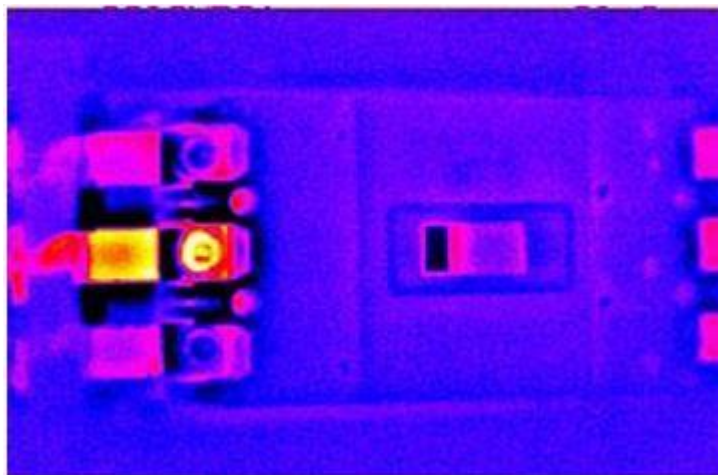
Figura 3.19-Exemplo de ligações desapertadas ou deterioradas [DMC]
