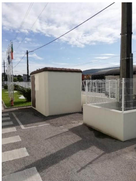
Figura 3.1-Cabine do posto de seccionamento
