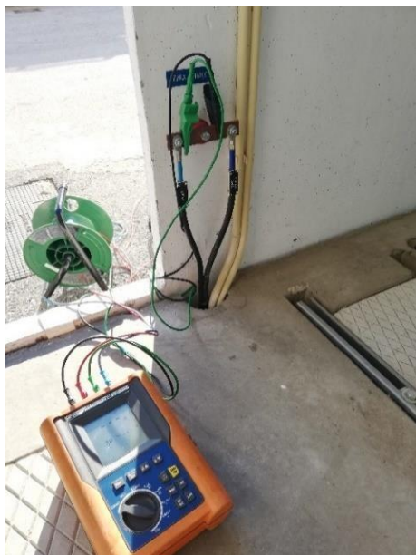
Figura 4.29-Equipamento utilizado para as medições de terras
