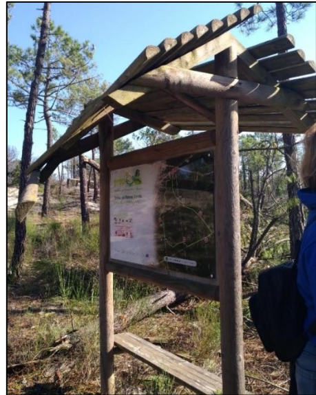
Figura 42: Verificação do estado do TBV após a Tempestade Leslie
