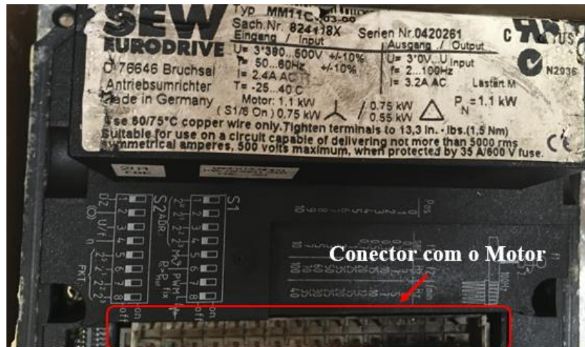
Figura 47 - Movimot MM11C-503-00 Danificado
