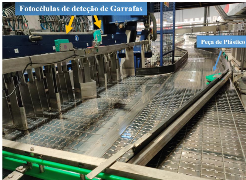
Figura 45 – Identificação das Fococélulas de Detecção de Garrafas na Engradadora Linha 5
