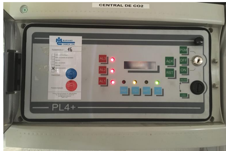
Figura 31 - Central de Alarme de CO 2
