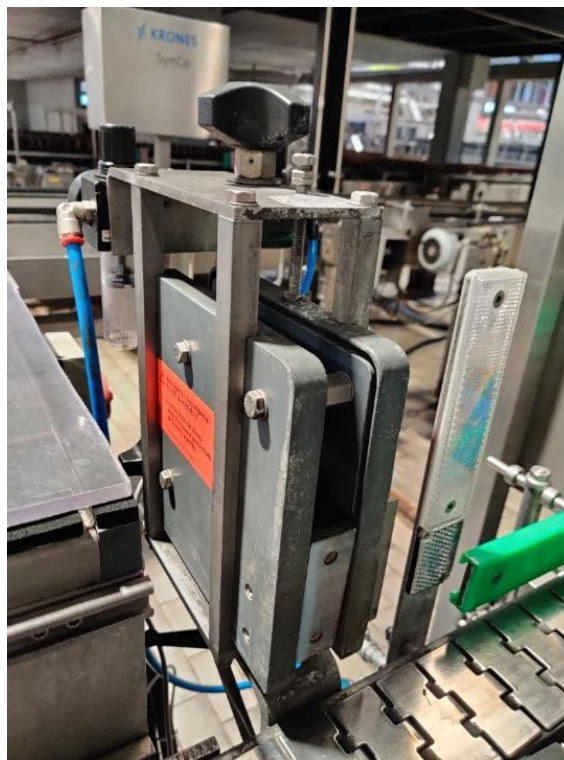
Figura 51 - Rejeitador Pneumático do Sistema de Rejeição Auxiliar da Linha 5
