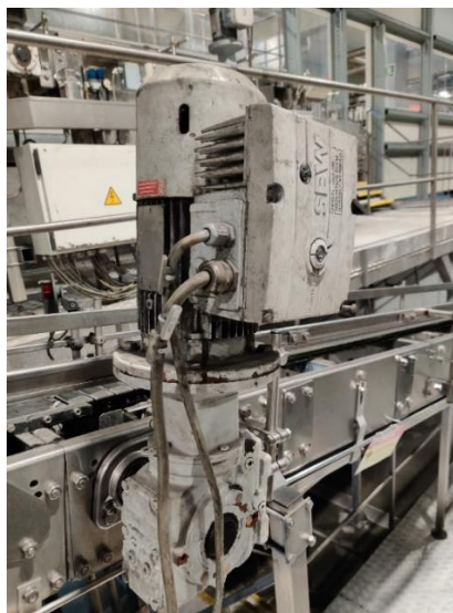
Figura 46 - Motor do Transportador de Grades da Linha 5
