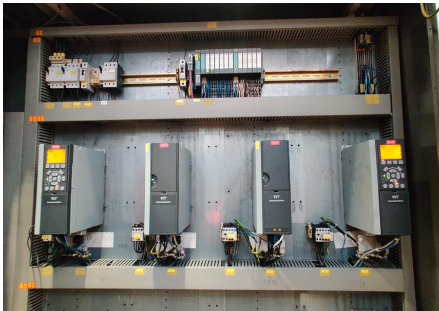
Figura 36 - Quadro Elétrico dos Transportes de Garrafas
