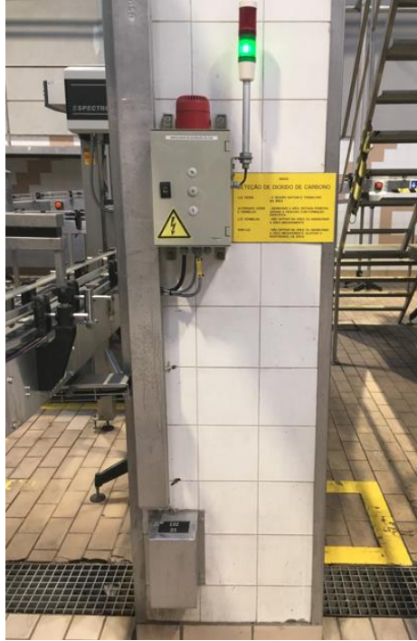
Figura 33 - Conjunto da Sinalização de CO2
