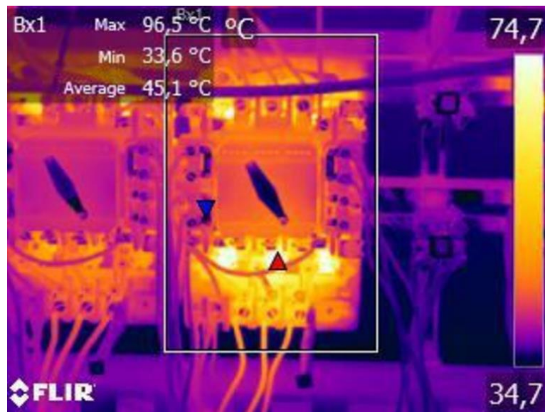
Figura 17 - Visão Termográfica de um Contactor no QE dos Silos
