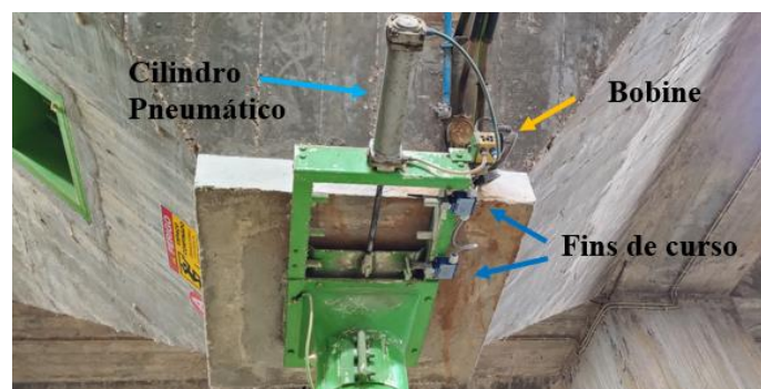
Figura 19 - Válvula de Fecho do Silo 22
