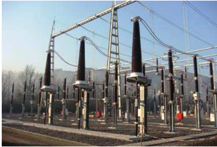
Figura 5.2 – Foto de uma subestação (E.I.P., 08/12/2012).
