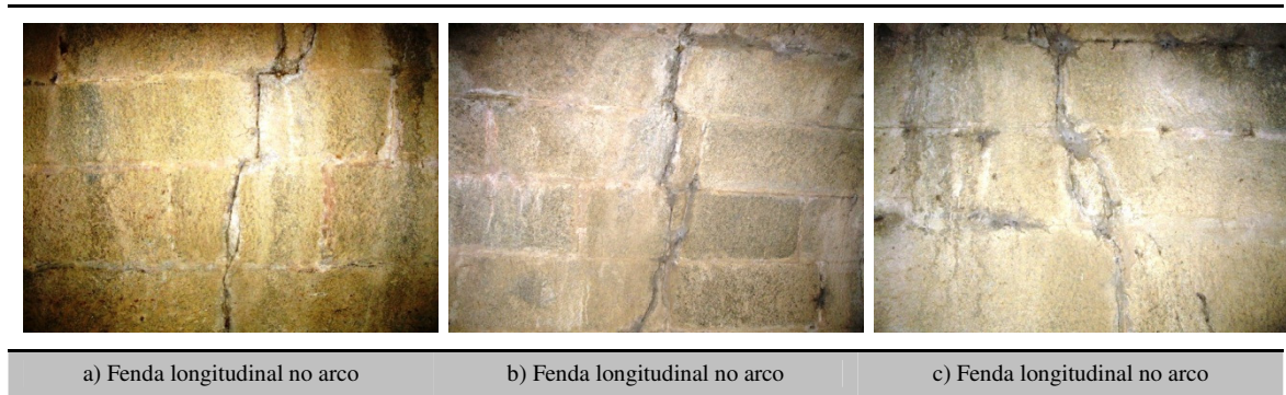
Figura 80 – Danos no PH ao Pk 178+436
