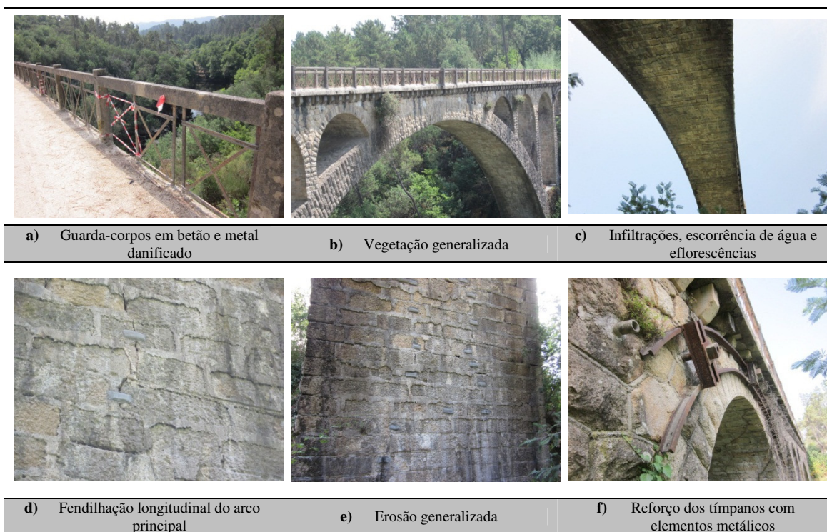
Figura 100 – Exemplos de danos na Ponte do Pego ao Pk 111+802
