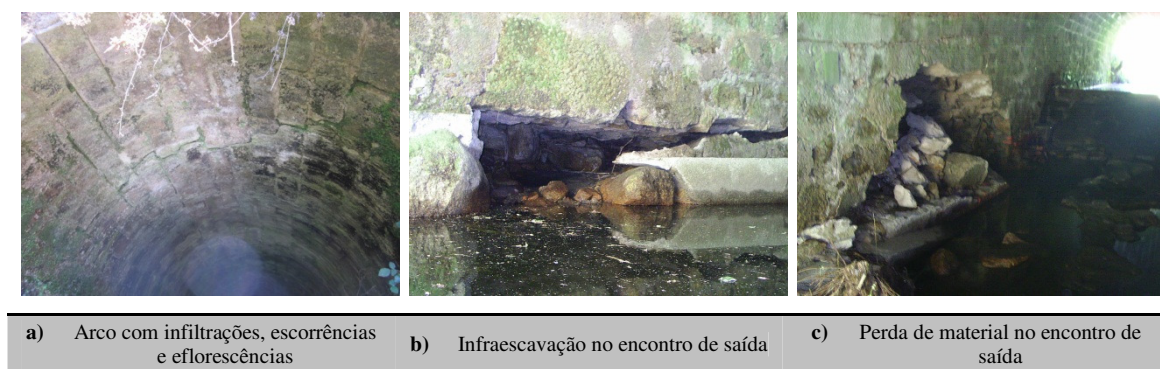
Figura 94 – Danos no PH ao Pk 085+482
