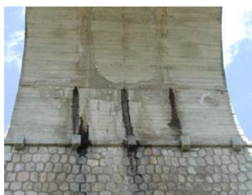
b) Manchas negras no arco
