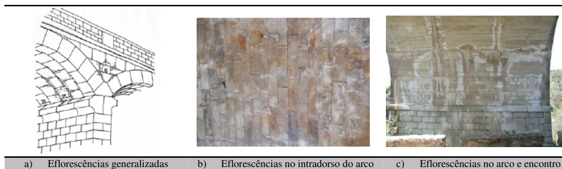
Figura 52 – Exemplos de eflorescências (Catalán e Álamo 2006)
