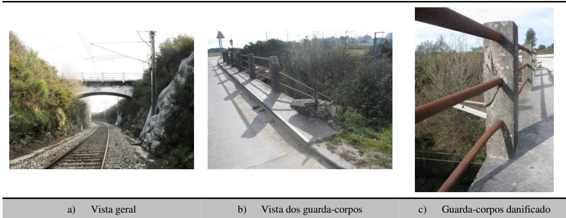
Figura 86 – Danos na PS ao Pk 106+100
