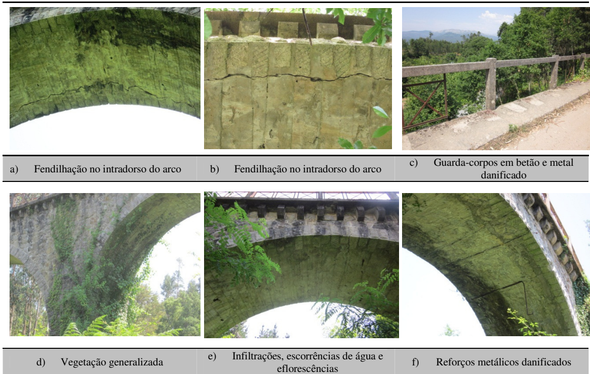
Figura 96 – Danos na ponte dos Melos ao Pk 092+561
