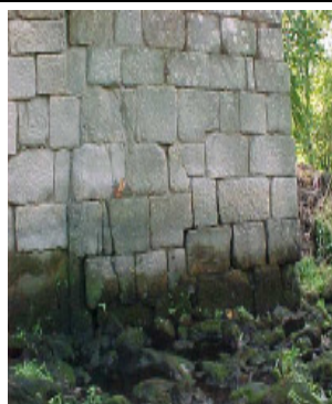
a) Presença de água por capilaridade
