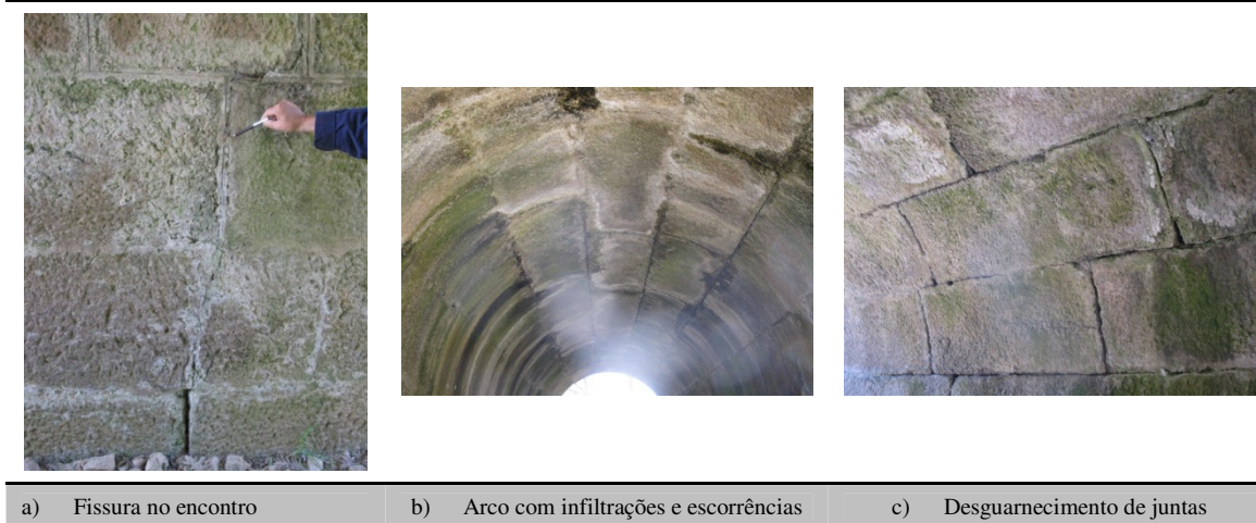
Figura 82 – Danos no PH ao Pk 224+986
