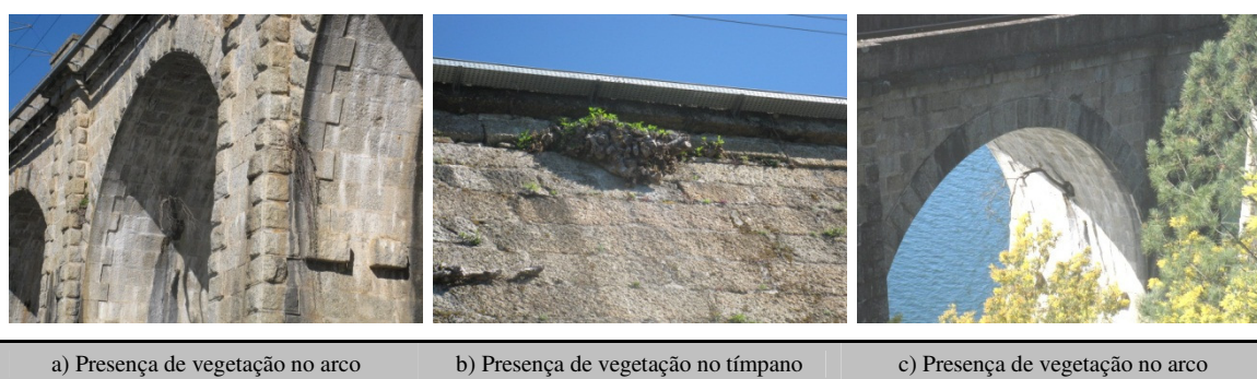
Figura 76 – Anomalias na ponte do Coval
