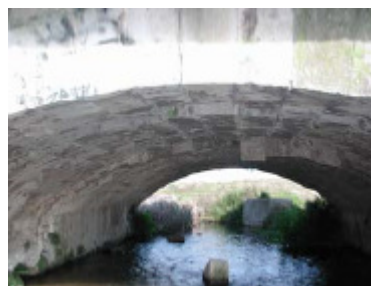
b) Destacamentos de pedras
