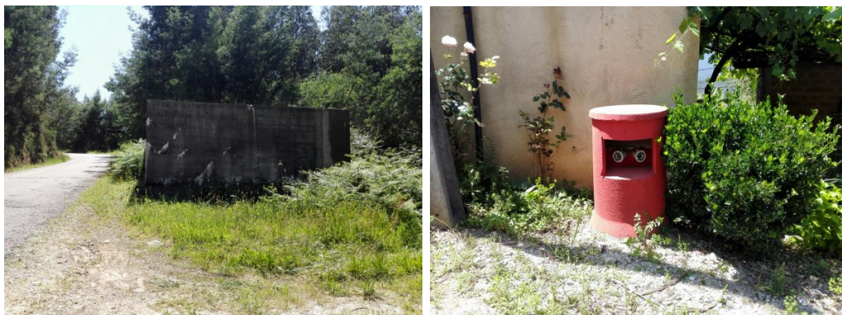
Figura 24 - Tanque e boca-de-incêndio em Alcafaz. maio 2022
