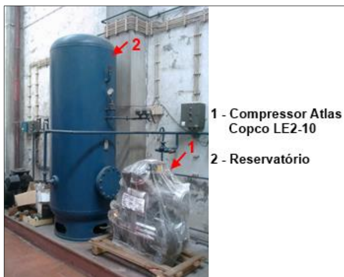
Figura 100 – Antigo reservatório e novo compressor Atlas Copco LE2-10.
