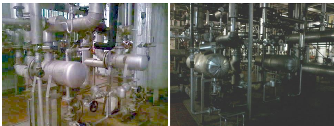
Figura 146 – Permutadores das AQS / Permutadores do aquecimento central.
