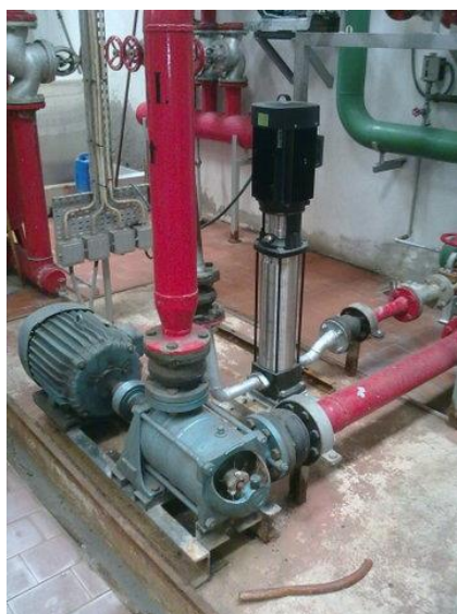
Figura 49 – Bombas de pressurização da rede de serviço de incêndios.
