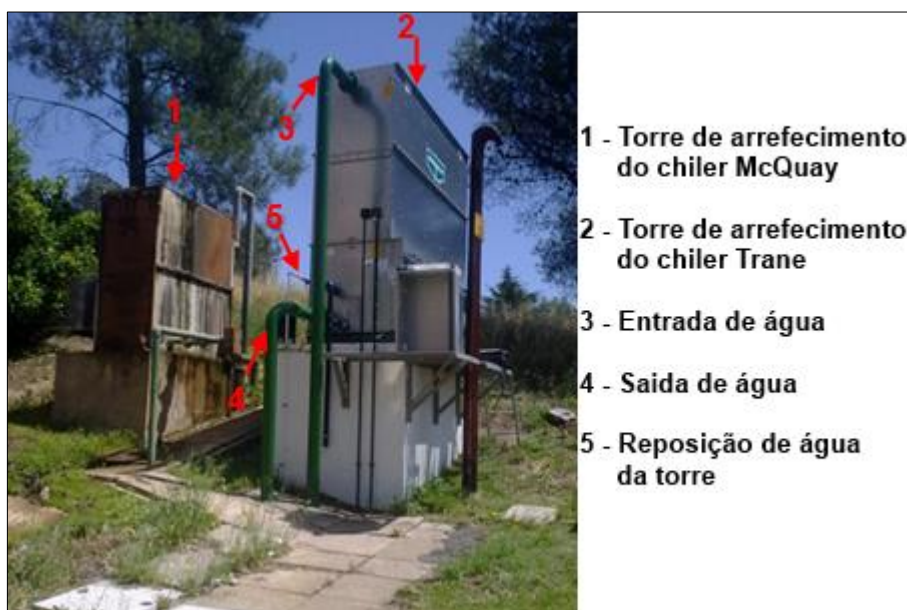
Figura 69 – Torres de arrefecimento.
