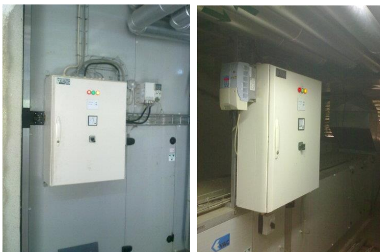
Figura 116 – Quadros eléctricos secundários AVAC do bloco operatório.
