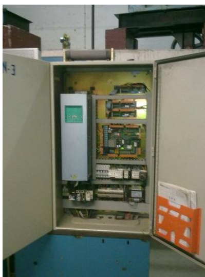
Figura 128 – Quadro de comando do elevador n.º4.
