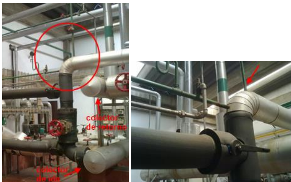
Figura 149 – Reposição de água no circuito de água refrigerada.
