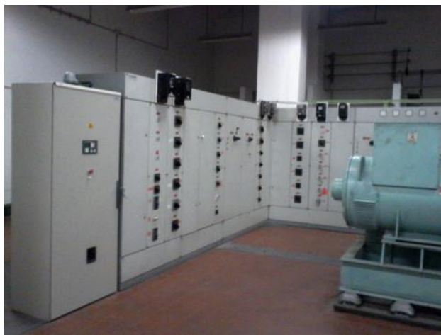
Figura 112 – Quadro geral de baixa tensão (QGBT).
