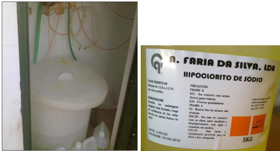
Figura 12 – Cabine de armazenagem de Hipoclorito de Sódio.
