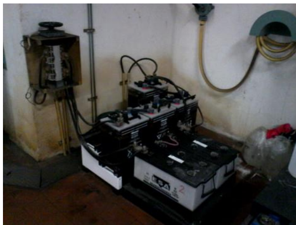
Figura 120 – Conjunto de baterias para o motor de arranque do gerador.
