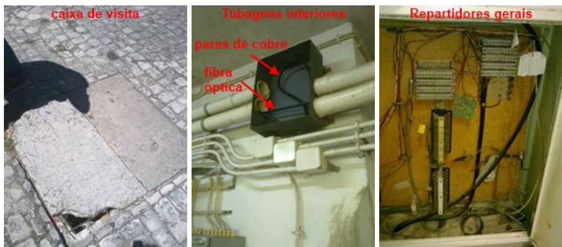
Figura 20 – Caixa de visita / Conduatas interiores / Repartidores gerais.
