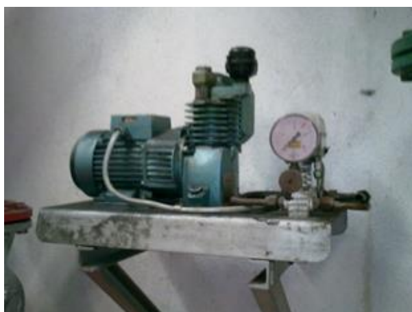
Figura 150 – Compressor destinado ao depósito da rede de incêndios.
