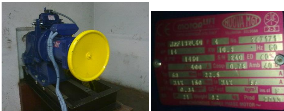
Figura 127 – Motor do elevador n.º2, da marca MOTORLIFT.
