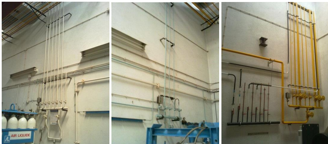
Figura 109 – Tubagens dos gases medicinais e sistema de aspiração.
