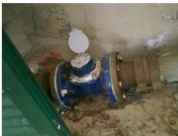
Figura 9 – Contador de água proveniente da rede pública.
