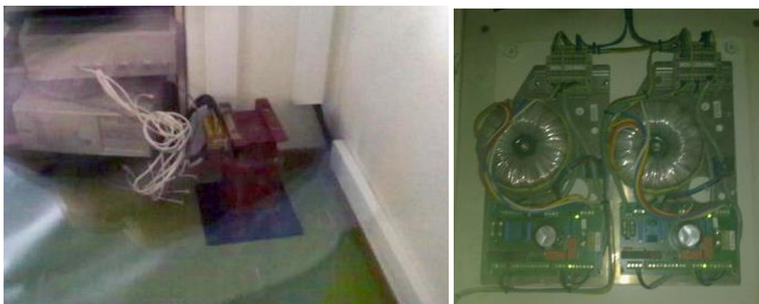
Figura 117 – Transformador de isolamento do UCIP / Transformador de isolamento da pequena cirurgia.
