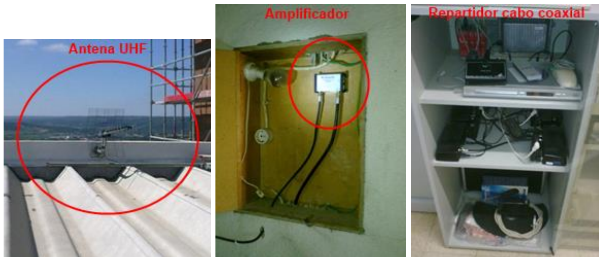
Figura 19 – Antena UHF / Amplificador / Repartidor de cabo coaxial.
