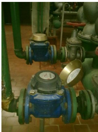
Figura 148 – Caudalímetros das AQS.
