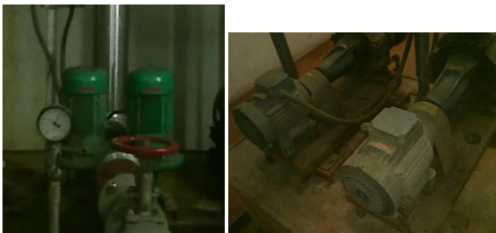
Figura 62 – Algumas das bombas utilizadas nas águas para aquecimento central.
