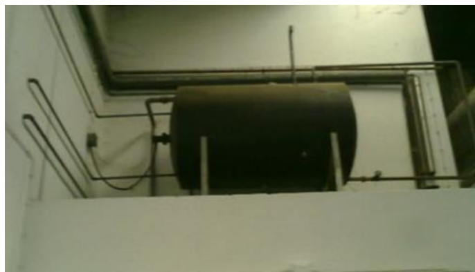
Figura 121 – Depósito de combustível do gerador.
