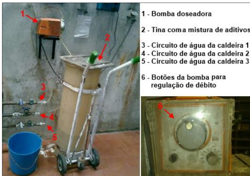
Figura 35 – Bomba centrífuga doseadora MC 38 das caldeiras.
