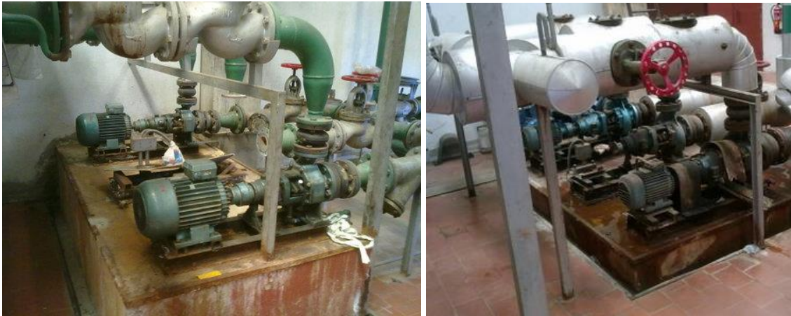
Figura 71 – Bombas centrífugas entre Torre de arrefecimento e Chiller / Bombas centrífugas entre Colector de retorno e Chiller.
