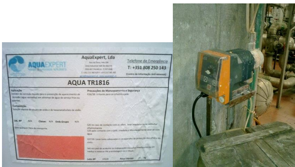
Figura 64 – Aditivo inibidor de corrosão / Bomba centrífuga doseadora.
