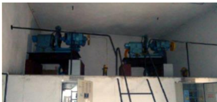
Figura 125 – Casa das máquinas do núcleo central, motor n.º 6 e 7.
