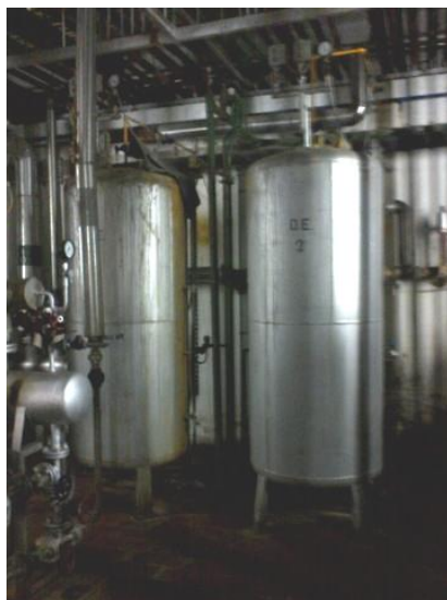
Figura 153 – Vasos de expansão do circuito de aquecimento central.
