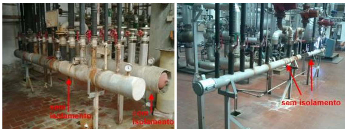
Figura 145 – Colectores das AQS.
