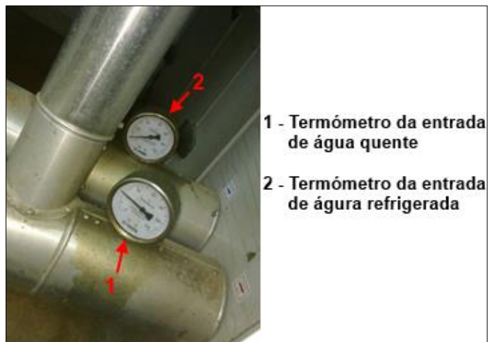
Figura 86 – Termómetros dos circuitos de água refrigerada e quente.
