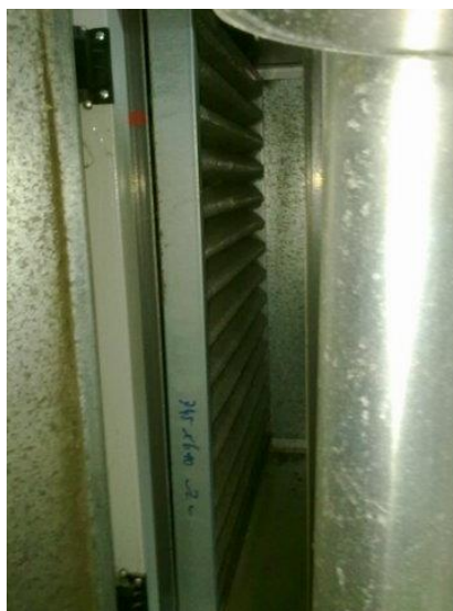
Figura 76 – Filtro primário F5.
