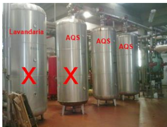
Figura 56 – Depósitos de inércia das AQS.
