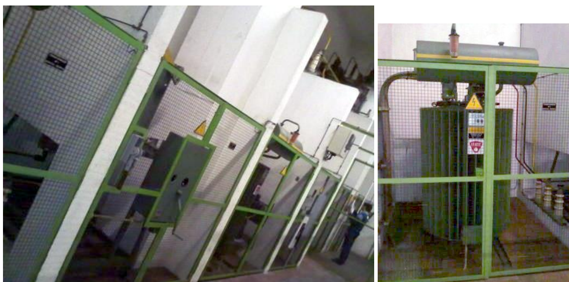
Figura 110 – Vista geral do PT / Transformador.
