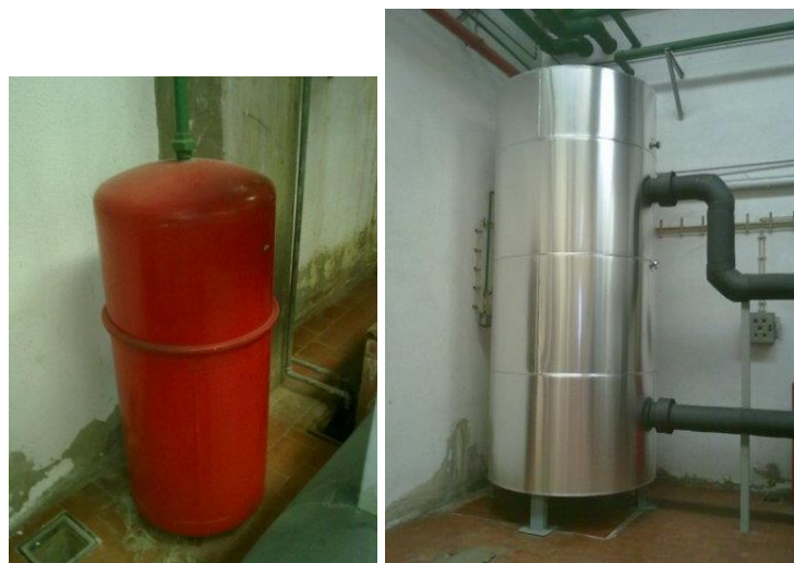
Figura 73 – Vaso de expansão / Depósito de inércia de água refrigerada.
