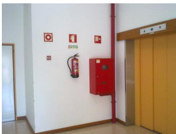
Figura 129 – Botão de alarme, extintor e boca-de-incêndio do piso 3.
