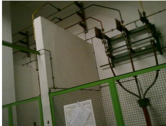
Figura 17 – Cella de entrada do PT.
