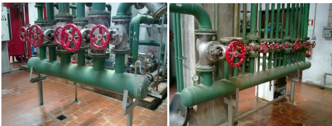
Figura 48 – Colector de distribuição de água a alta pressão / Colector de distribuição de água a baixa pressão.
