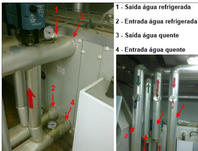
Figura 77 – Entrada de água quente e água refrigerada, nas respectivas baterias.
