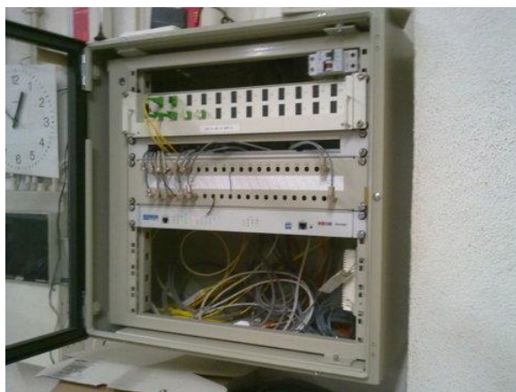
Figura 21 – Ponto de distribuição da central telefónica do piso 0.
