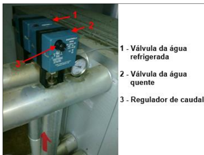
Figura 87 – Válvulas motorizadas de três vias.
