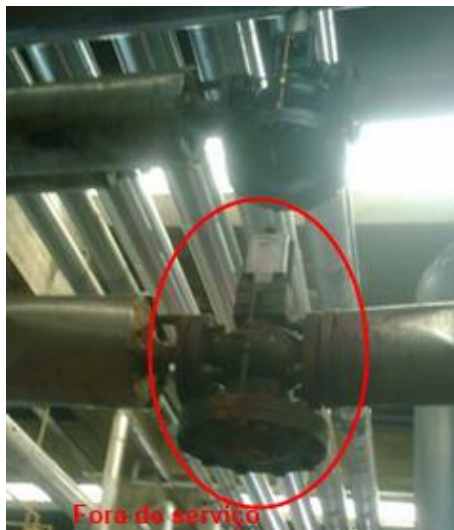
Figura 147 – Válvulas de redução de pressão do vapor.
