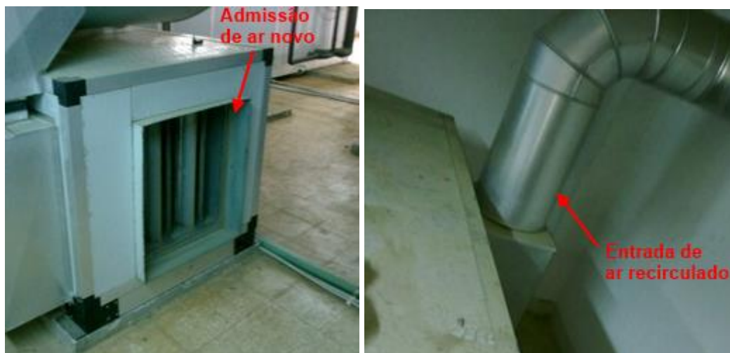
Figura 75 – Entrada de ar na UTA / Condução de ar recirculado.
