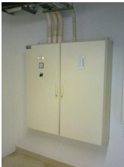
Figura 115 – Quadro eléctrico principal AVAC do bloco operatório.
