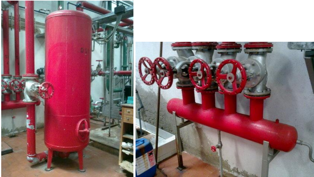
Figura 50 – Depósito sobre pressão de água para rede de incêndios / Colector de distribuição de água para a rede de incêndios.
