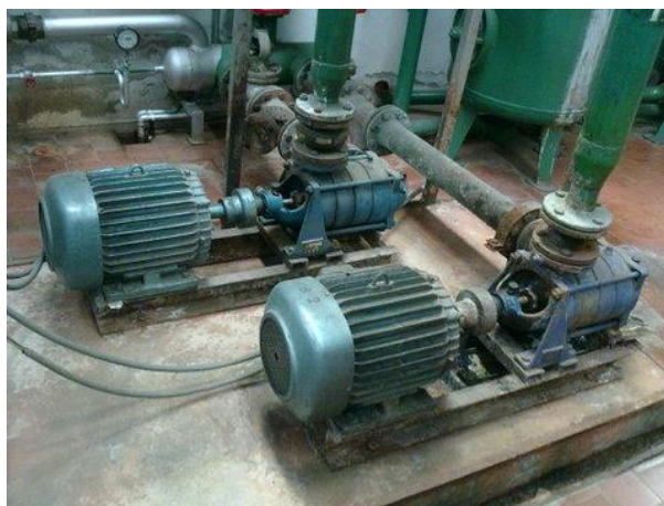
Figura 47 – Bombas de pressurização da distribuição de água.
