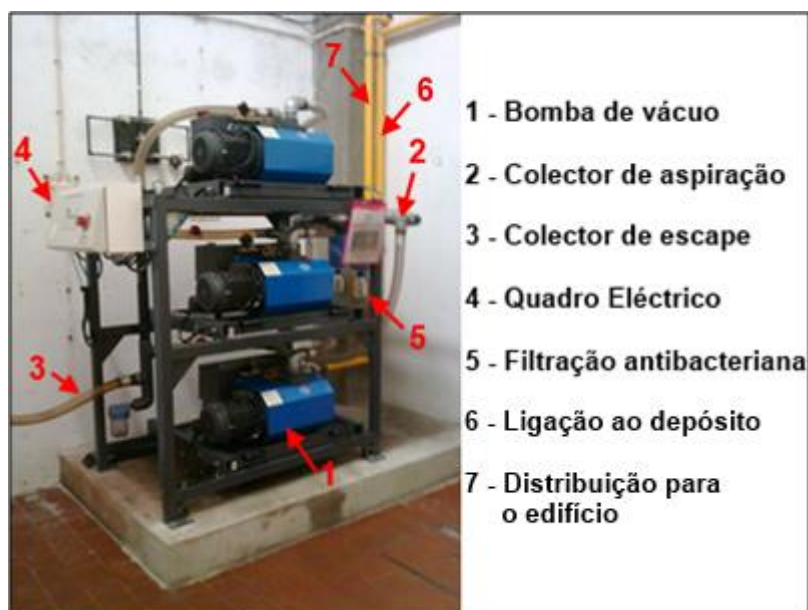
Figura 107 – Unidade de vácuo “HOSPIVAC V” da marca MIL'S.
