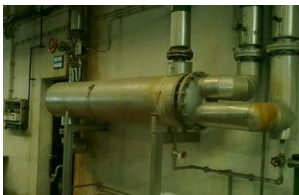
Figura 143 – Permutador de aproveitamento dos gases de combustão das caldeiras.
