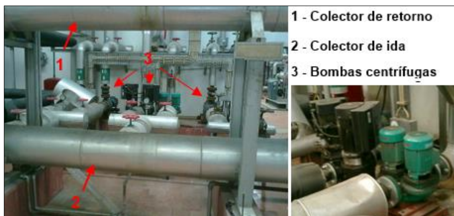
Figura 72 – Bombas centrífugas entre colector de ida e respectivos pisos.
