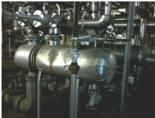
Figura 144 – Permutador do aquecimento central.
