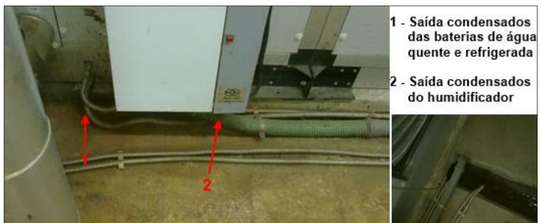
Figura 94 – Tubos de esgoto das baterias de água e do humidificador das UTA.
