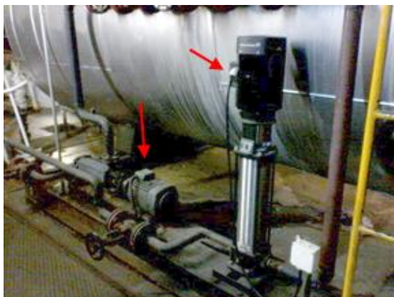
Figura 29 – Bombas de alimentação à caldeira 2.
