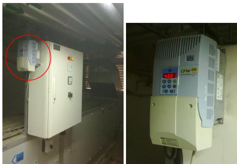
Figura 88 – Variador de velocidade CFW-08.
