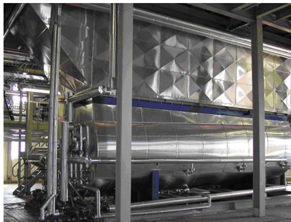
Figura 20 - Tanque aquecimento das estearinas.
