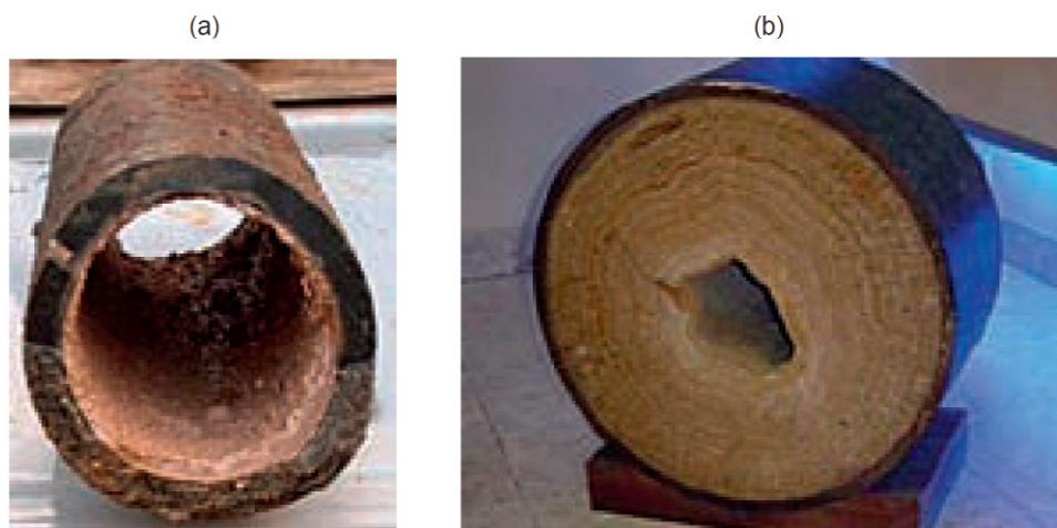
Ilustração 8 - Exemplo de incrustação em conduta de a) Material cimentício (fibrocimento) e b) conduta metálica
