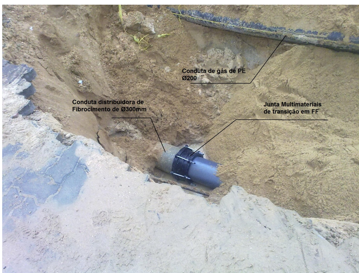
Ilustração 11 - Rotura já reparada, vala ainda aberta
