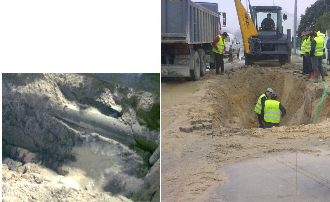
Ilustração 12 – a) Rotura na conduta de Fibrocimento de Ø300 b) Reparação da rotura
