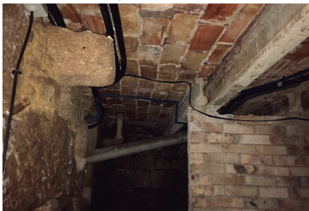
Figura 153 - forjado oeste en semisotano - autor
