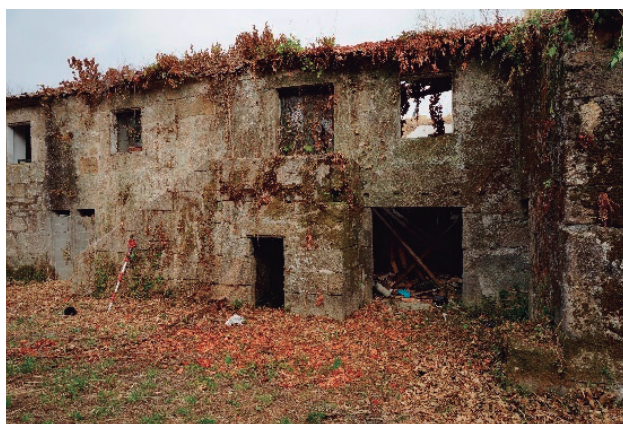
Figura 352 - ausencia de carpinterías en vanos fachada oeste - autor
