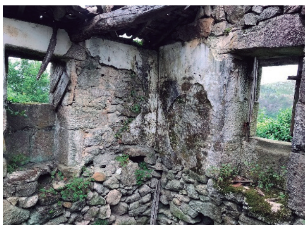
Figura 23 – abocinamiento en vanos - autor
