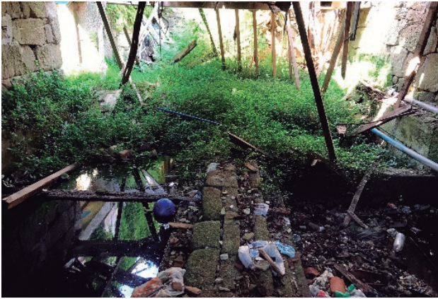
Figura 331 - desplome forjado planta primera - autor
