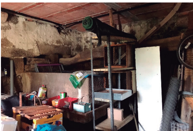
Figura 154 - forjado oeste en semisotano - autor
