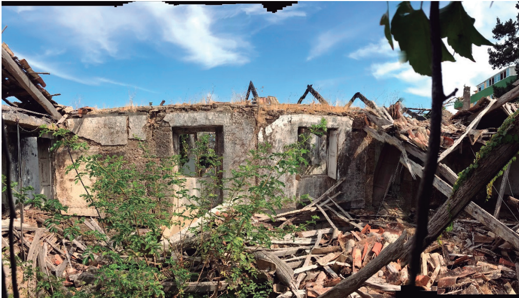
Figura 288 - estado interior entre naves - autor
