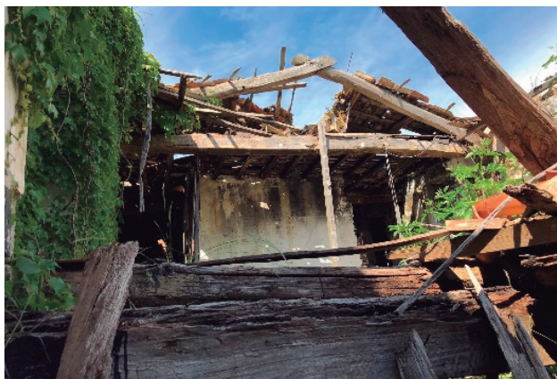
Figura 338 - desplome de cubierta sobre dormitorios y pilas salazon - autor
