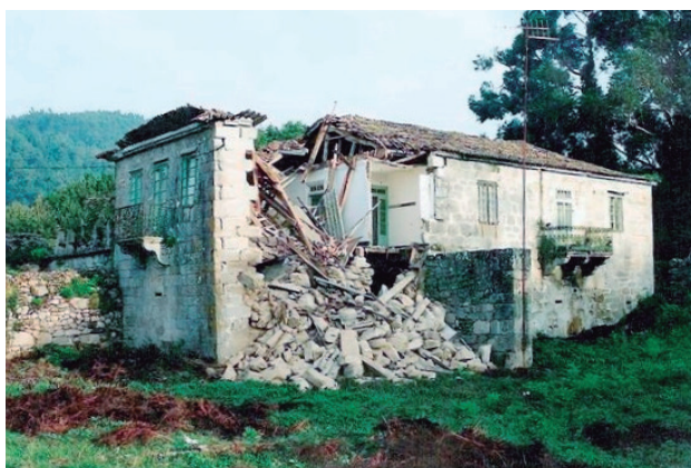
Figura 101 - estado derruido 1998 - http://www.delmorrazo.com/
