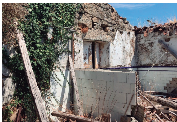
Figura 335 - ausencia de cubierta sobre baños - autor
