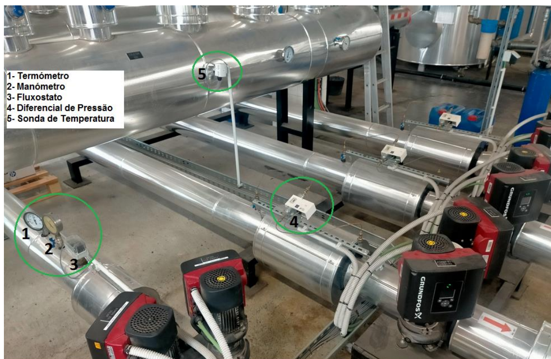
Figura 3-3- Imagem Central Térmica (termómetros, manómetros, fluxostatos, diferenciais de pressão, sondas de temperatura, etc).
