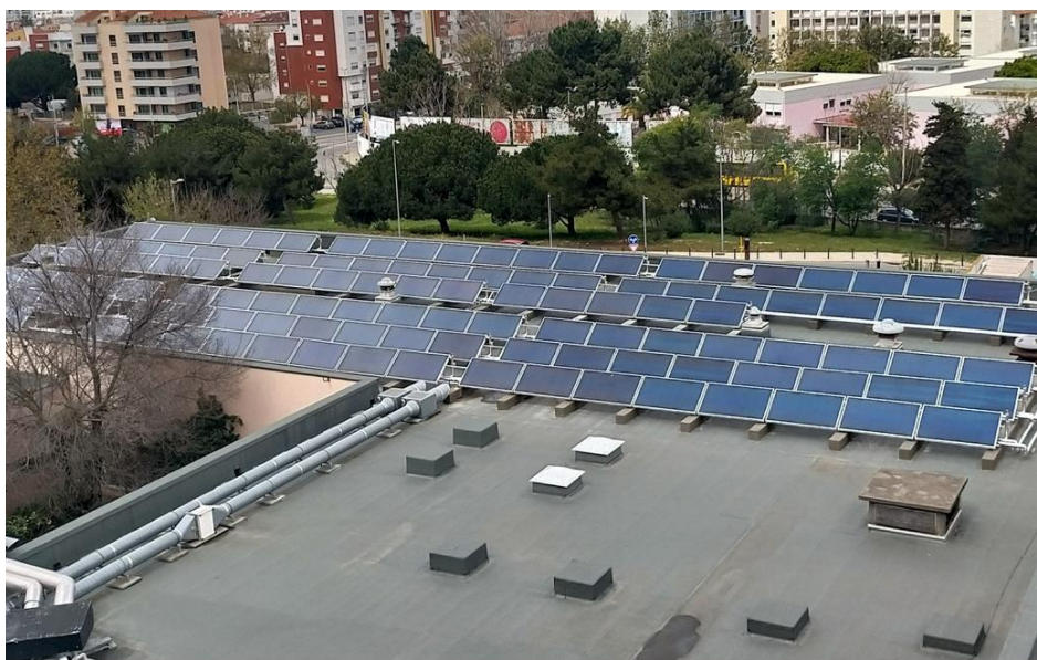
Figura 3-13- Instalação Solar Térmico do Centro Hospitalar.
