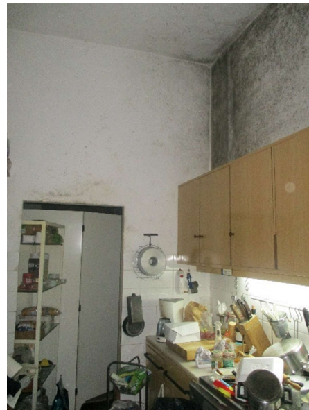
Figura 52 – Atual Cozinha. Novo vão de acesso à sala de refeições e estado da parede com instalações de canalizações e equipamentos.
