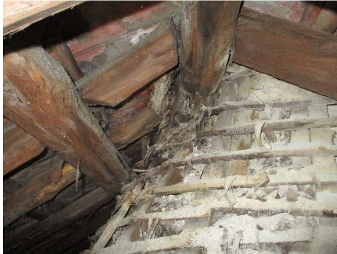
Figura 50 – Infiltração pelo remate entre a claraboia e o pau fileira.
