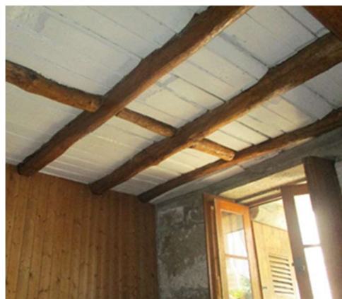
Figura 6 – Fotografia do objeto de estudo visto a partir da Cave: estrutura do vigamento em pau rolado com soalho colocado diretamente sobre o mesmo.
