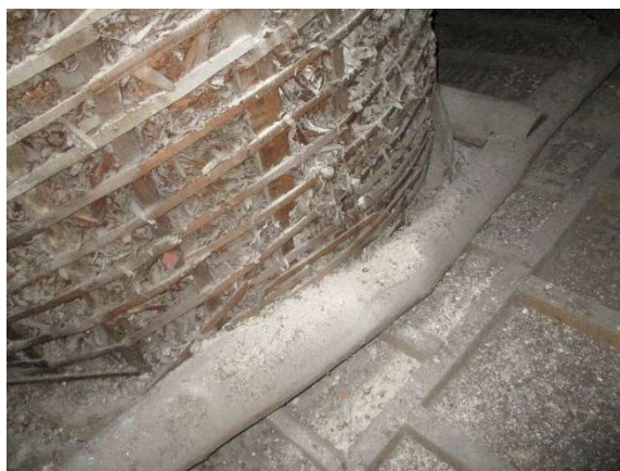
Figura 18 – Vigas e tarugo em pau rolado a servir de apoio à estrutura da claraboia.
