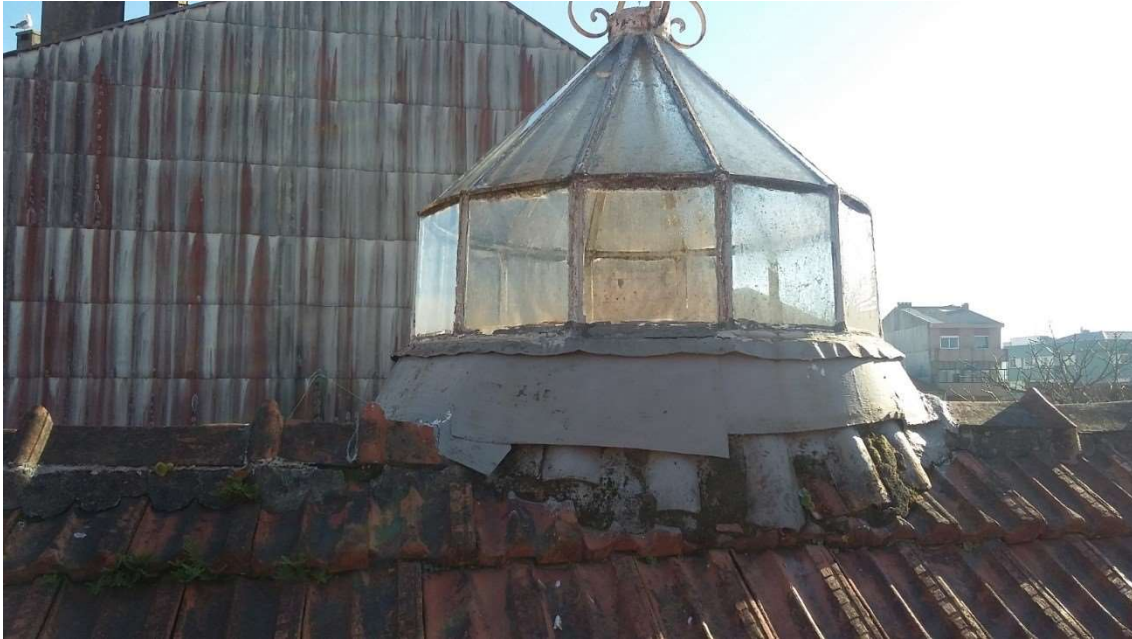
Figura 18 – Imagem da estrutura de Metal e vidro que compõem a claraboia circular.
