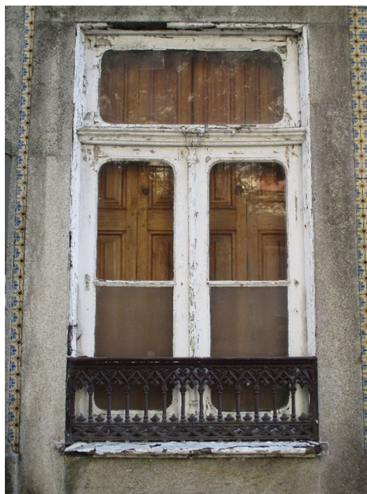
Figura 23 – Janela de peito de batente com guarda de ferro, na fachada frontal no piso ao nível da rua.
