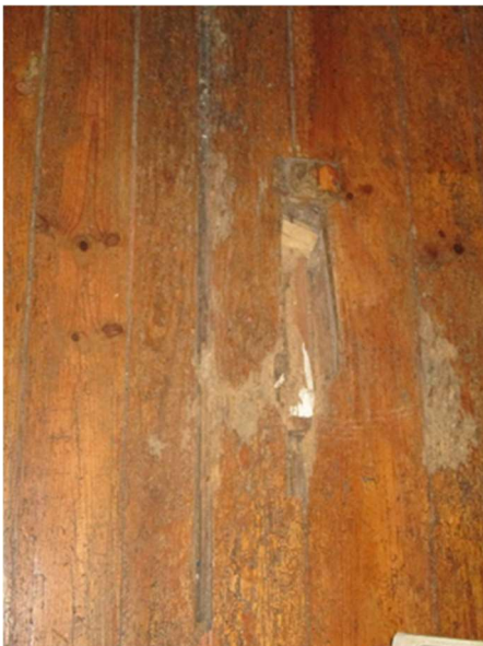
Figura 51 – Estado do soalho na atual cozinha.
