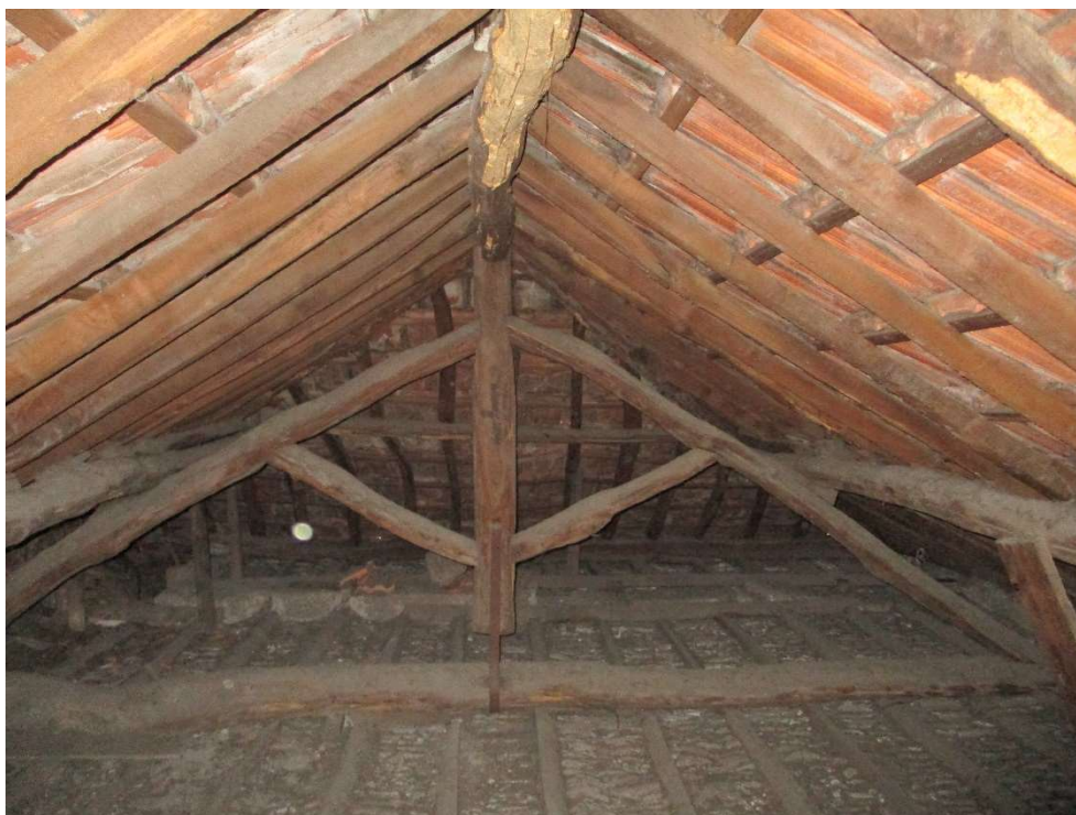
Figura 10 – Fotografia da estrutura da cobertura do objeto de estudo. Sistema com uso a telha Marselha sem tabuado entre as varas e o ripado de suporte das telhas.
