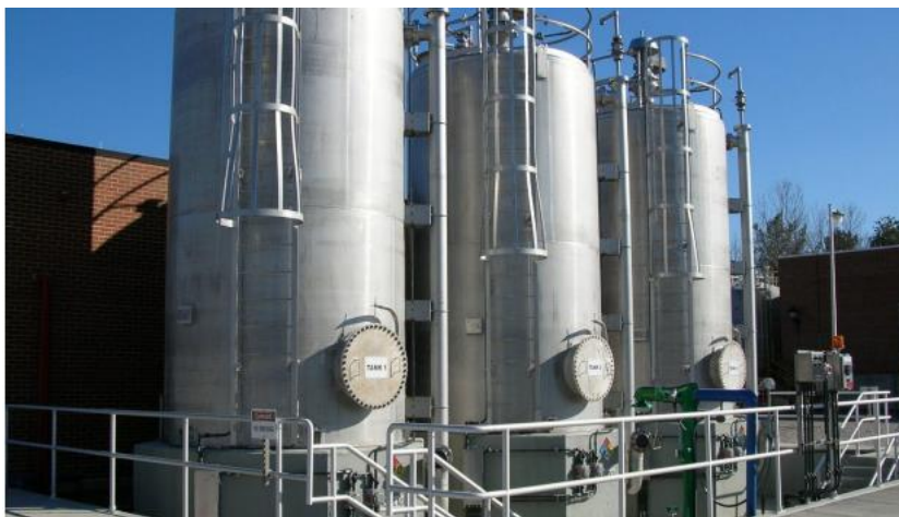
Figura 5: Tanques de armazenamento de metanol [3].
