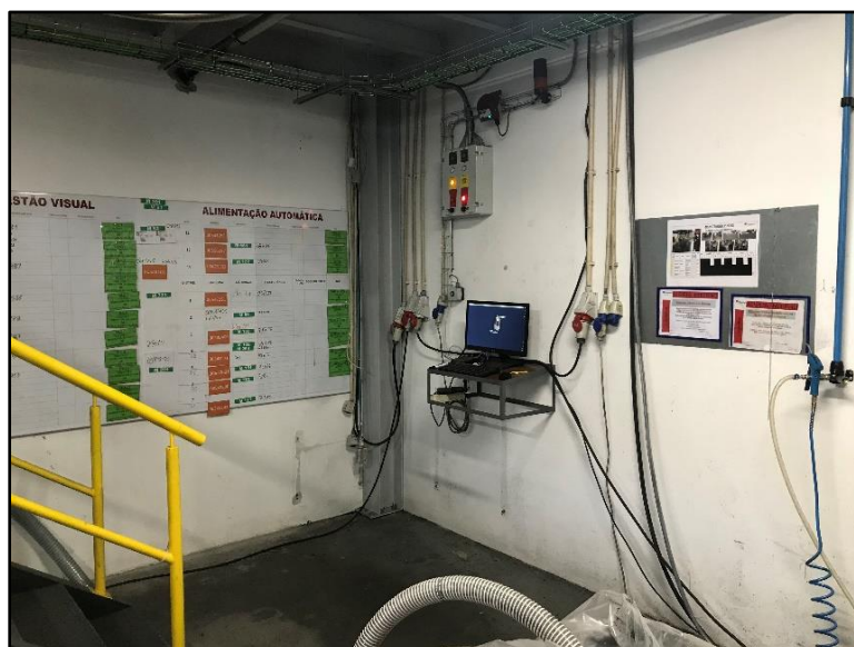
Figura 5.4 – Estado inicial da zona do Painel de Gestão Visual e do Computador que gere o sistema de Alimentação Automática
