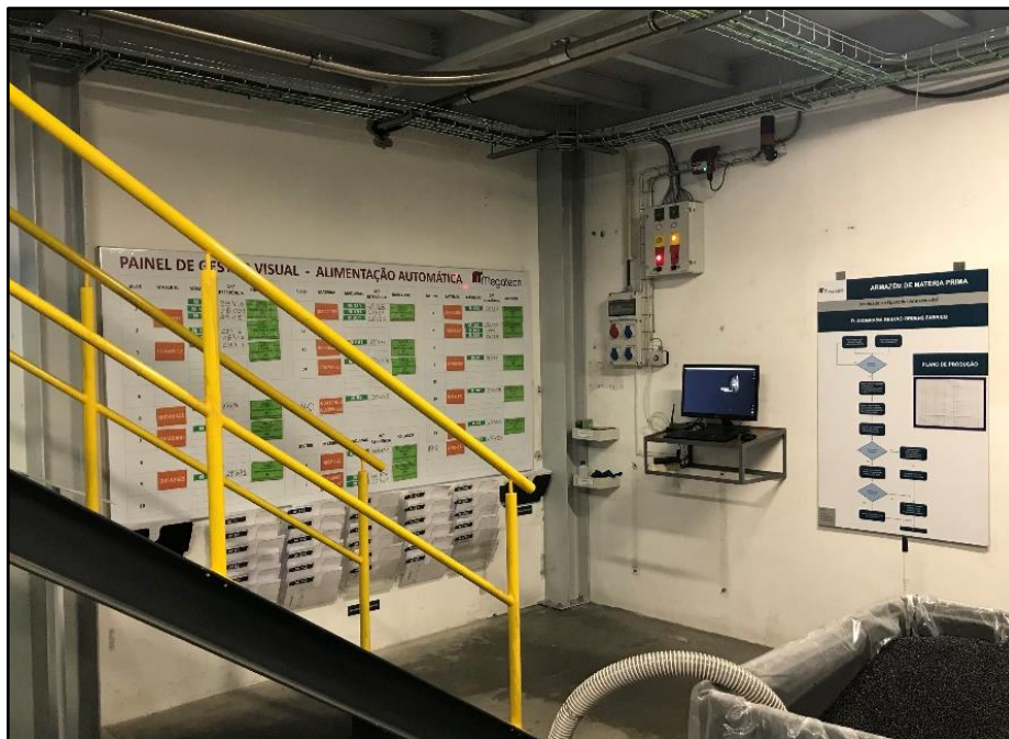
Figura 5.13 - Melhorias na zona do Painel de Gestão Visual e do Computador que gere o sistema de Alimentação Automática
