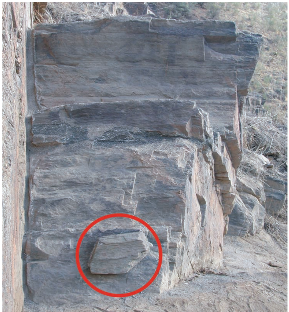
fig. 12, 13 e 14 Preenchimento de lacunas e fracturas com argamassa hidráulica à base de C30 (em cima, à esq.); ancoragem de um pequeno fragmento de xisto, propositadamente descontextualizado, com pernos de fibra de vidro, embebidos em resina epoxídica e argamassa fluida (em cima, à esq. e em baixo).
