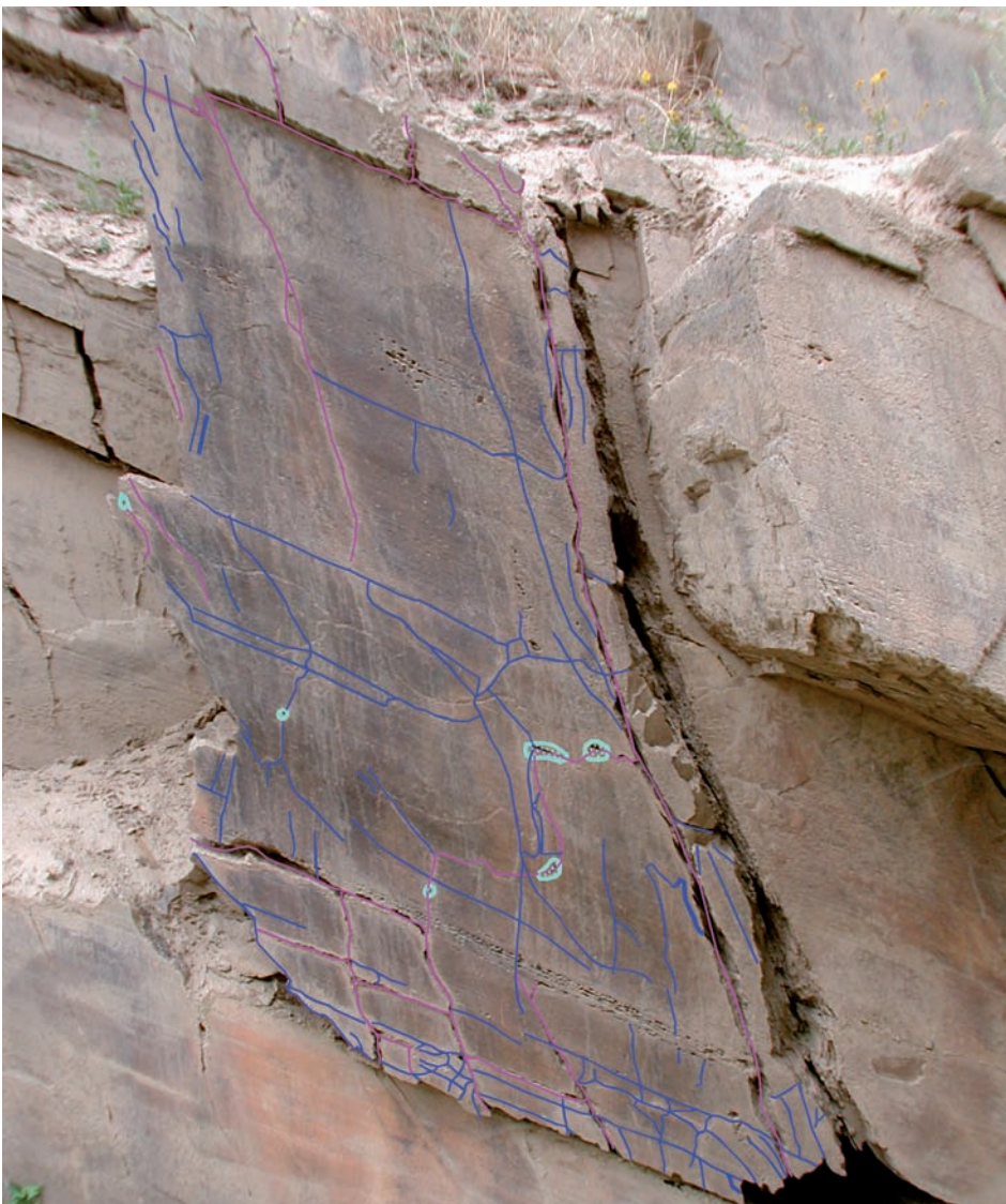
fig. 5 Exemplo do registo cartográfico das formas de alteração e degradação encontradas na rocha 1, neste caso as fissuras, fracturas e lacunas.
