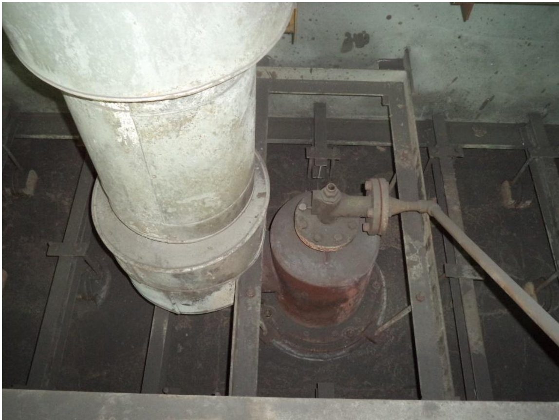
Figura 60 - Queimador de teto das zonas 1 e 2
