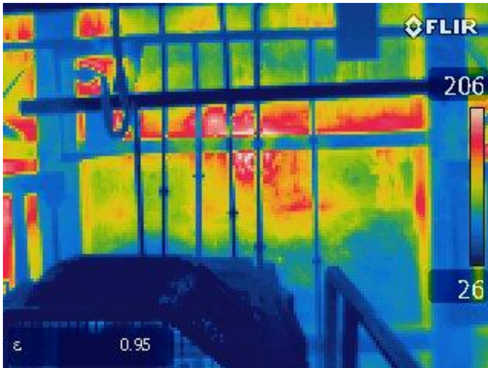
Figura 96 - Análise termográfica á fachada lateral Sul
