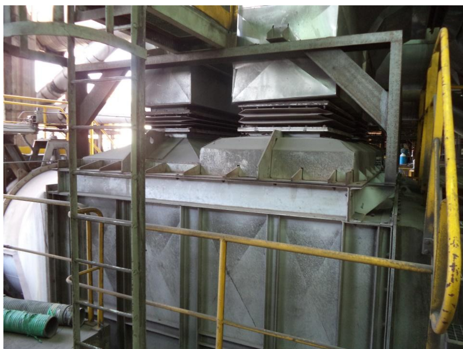
Figura 73 - Vista exterior do recuperador de calor
