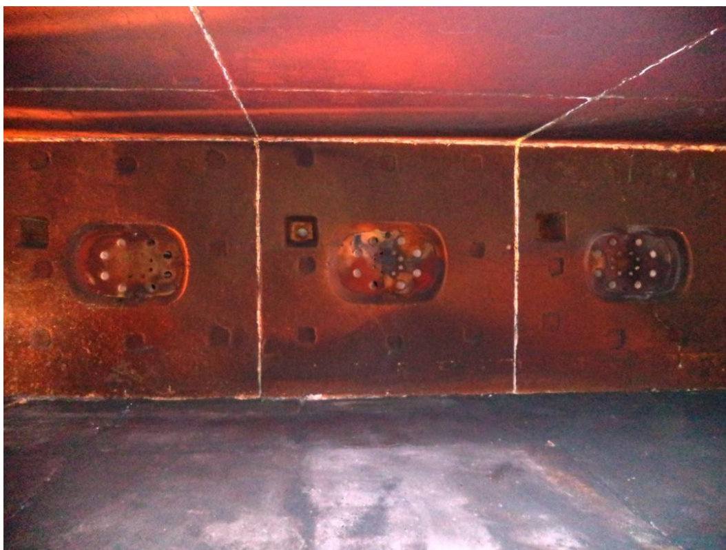
Figura 59 - Queimadores de parede
