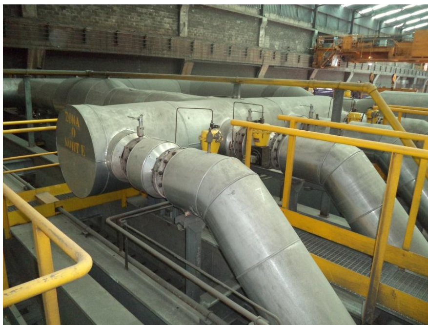
Figura 57 - Condutas de ar de combustão zona 0
