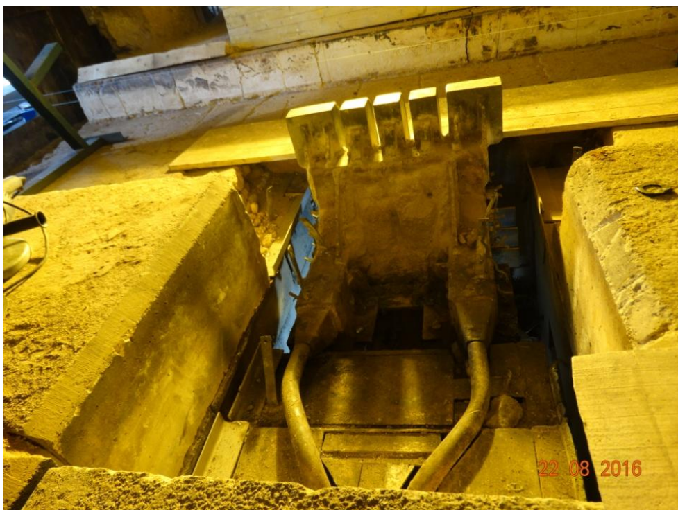
Figura 77 - Pormenor da refrigeração de um langeron móvel
