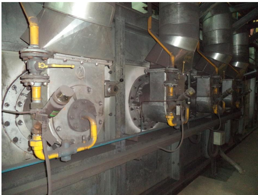
Figura 56 - Queimadores de parede da fachada sul
