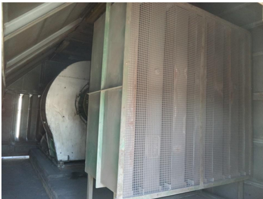
Figura 91 - Sistema de ventilação nº 1
