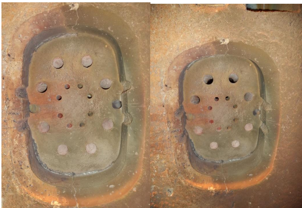
Figura 58 - Queimadores de parede
