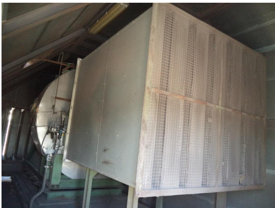
Figura 92 - Sistema de ventilação nº 2
