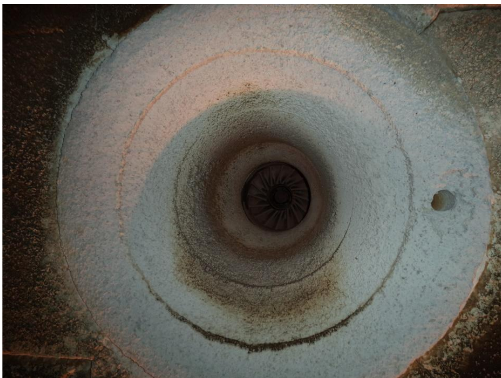
Figura 61 - Queimador de teto (interior do forno)
