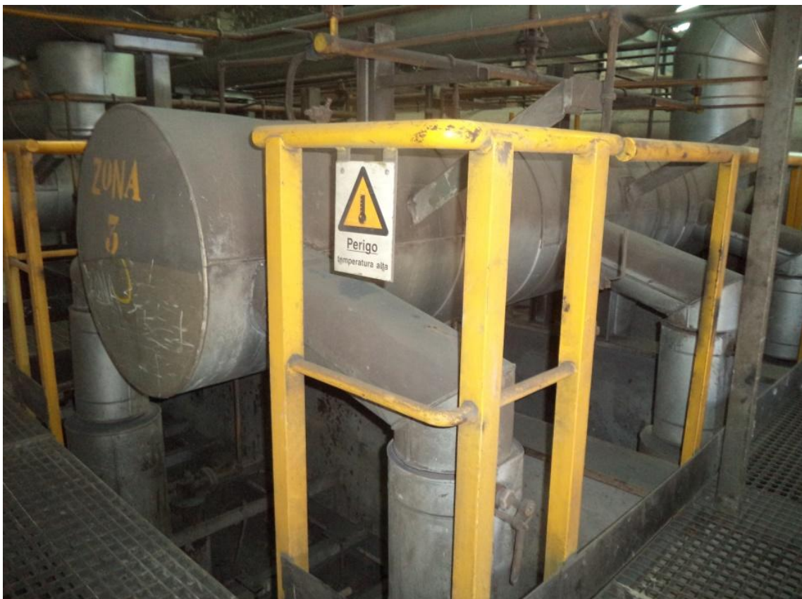
Figura 63 - Condutas do ar de combustão da zona 5
