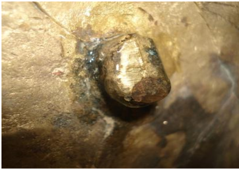
18 Aspecto da limpeza da interior (baixo) do objecto. Corrosão verde; (Fonte: Autor)
