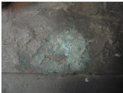
4 Corrosão de cor verde activa e pulverulenta.(Fonte: Autor)
