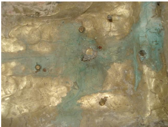
11 Pormenor da corrosão activa na parte de dentro do objecto (Fonte: Autor)
