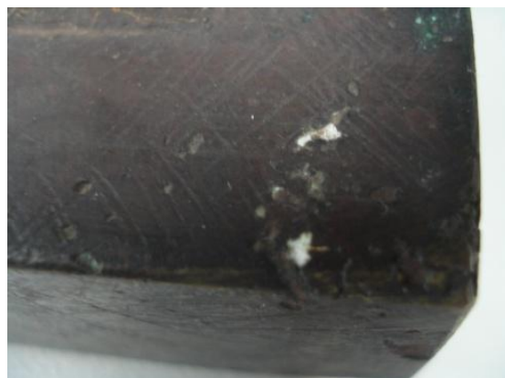
3 Aspecto da corrosão de cor verde, pontual, e de vestígios de uma tinta branca que se desconhece a sua origem;
