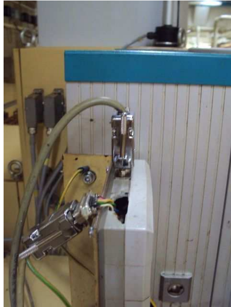
Figura 24 - Conector de comunicação caído
