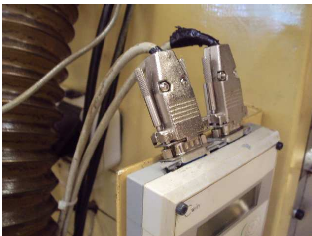
Figura 23 - Conectores de comunicação danificados
