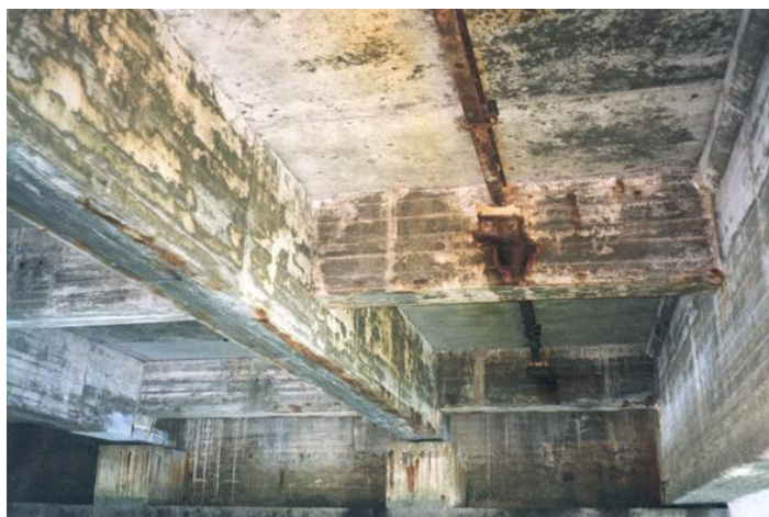
Figura 6-16. Estado de degradação da estrutura (a2p estudos e projetos, 2004).
