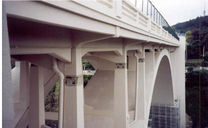
Figura 6-14. Vista geral do viaduto Duarte Pacheco após intervenção (APPLETON, J: et al, 2004).
