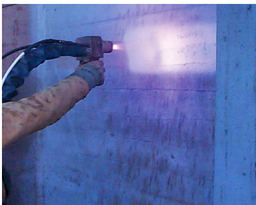
Figura 5-17. Aplicação de metais por projeção em estrutura de betão armado (Structural Technologies, 2015).
