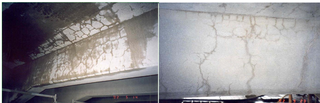
Figura 6-8. Fendilhação das reações alcali-sílica no betão nas vigas do tabuleiro (APPLETON, J: et al, 2004).
