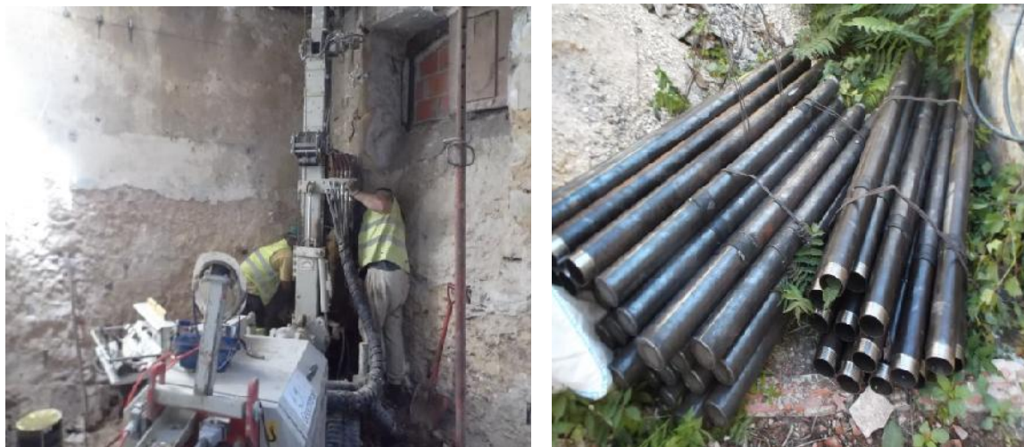
Figura 88. Equipamento e respectivos acessórios (tubos).
