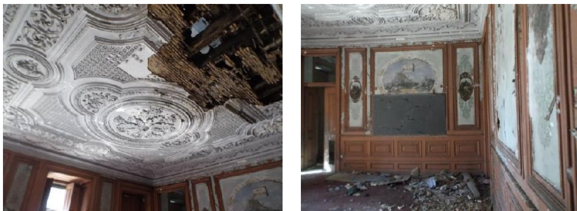
Figura 8. Degradação das paredes, tetos e pavimentos do piso térreo.
