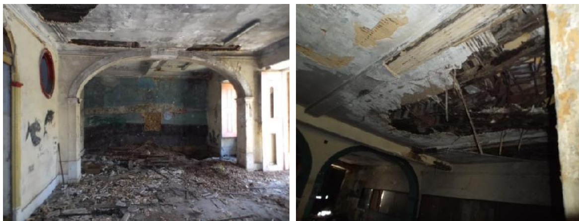
Figura 9. Degradação das paredes e pavimentos da Sala Nobre do piso 1.
