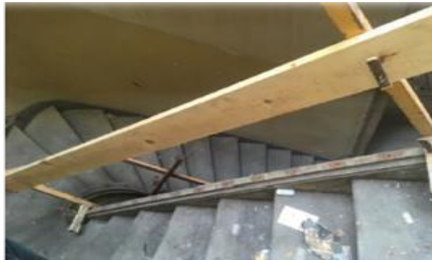
Figura 113. Falta de um lanço de guarda-corpos.
