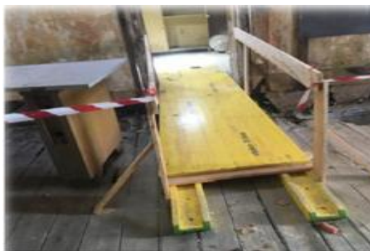
Figura 112. Plataforma de acesso.
