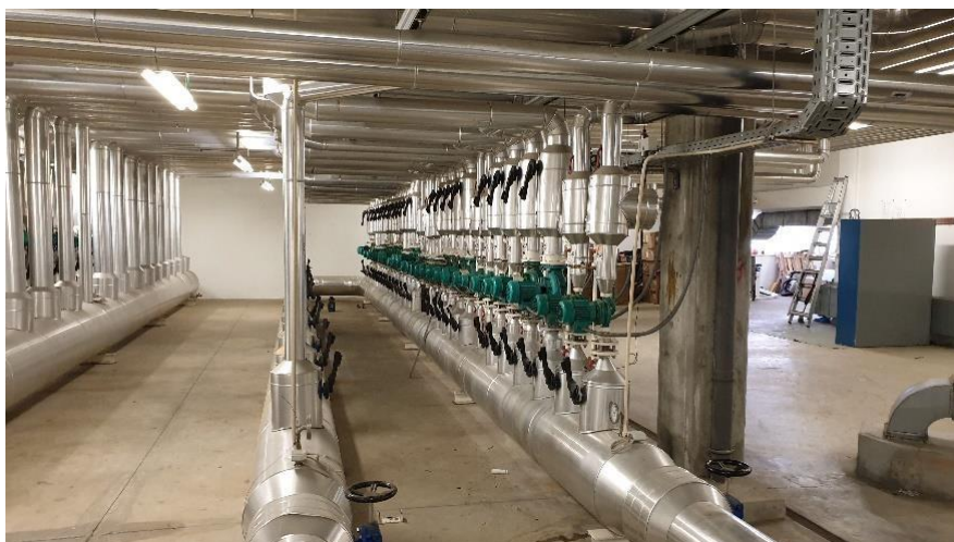
Figura 4. 6 – Coletor de distribuição de água quente e água gelada
