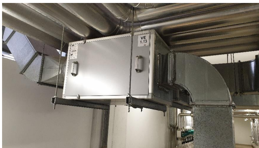
Figura 4. 4 – Ventiladores de extração
