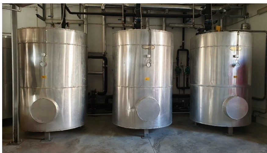
Figura 4. 11 – Depósitos de Água Quente no Hospital Pediátrico
