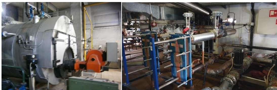
Figura 3. 3 – Geradores de vapor e permutadores
