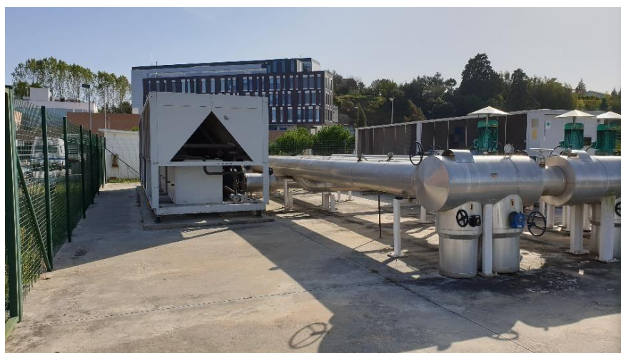
Figura 4. 9 – Chillers no Hospital Pediátrico
