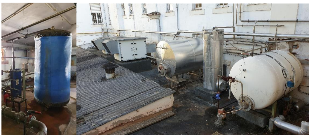
Figura 3. 5 - Depósitos para armazenamento de AQS
