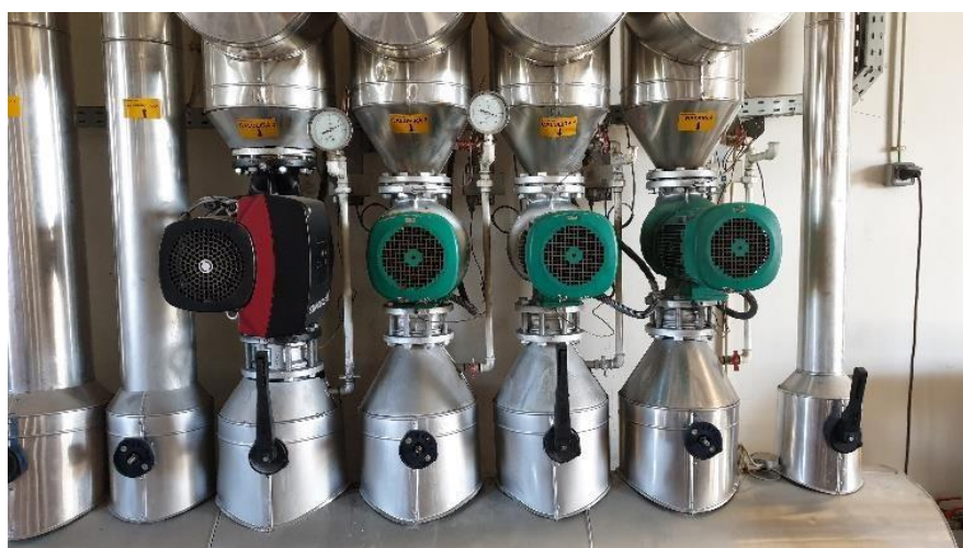
Figura 4. 5 – Bombas de circulação de um dos coletores de distribuição de água quente
