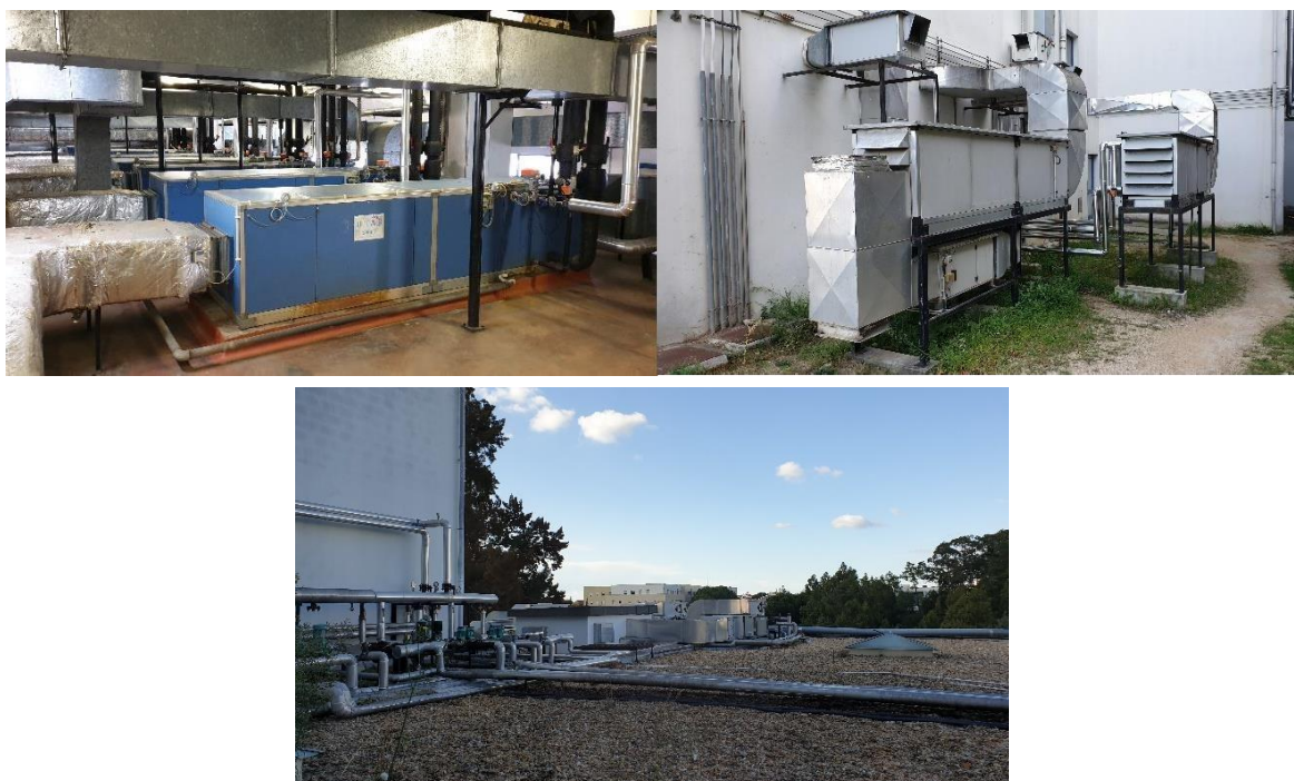
Figura 3. 7 - Unidades de Tratamento de Ar (UTA)
