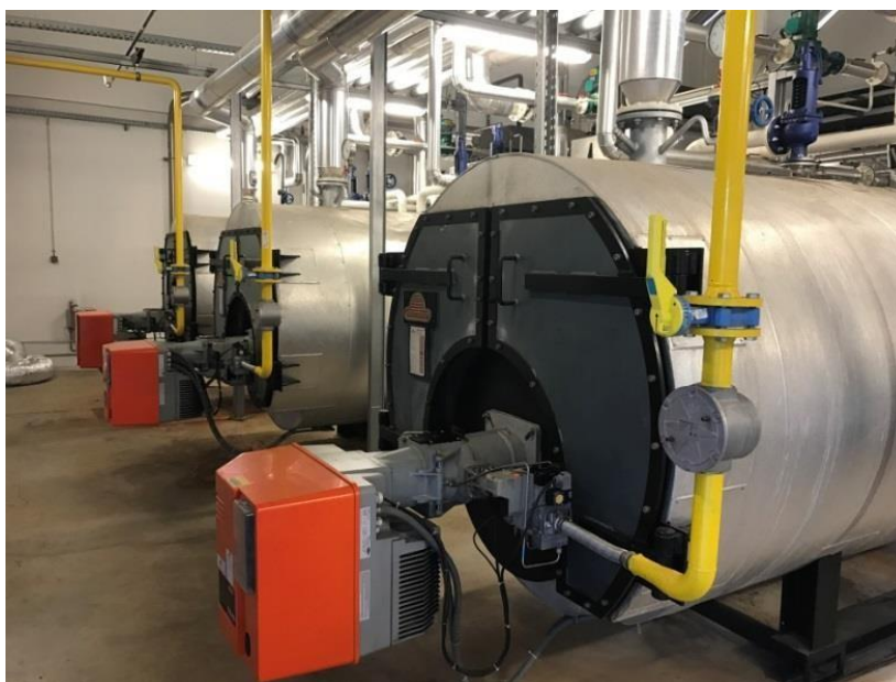
Figura 4. 8 – Caldeiras a Gás Natural
