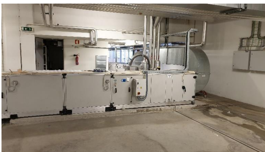
Figura 4. 7 – UTA com os respetivos circuitos do fluido térmico
