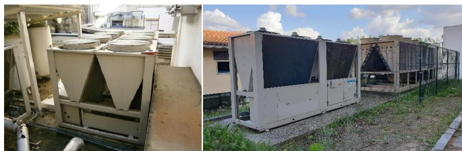
Figura 3. 2 - Hospital Geral - equipamentos do tipo chiller
