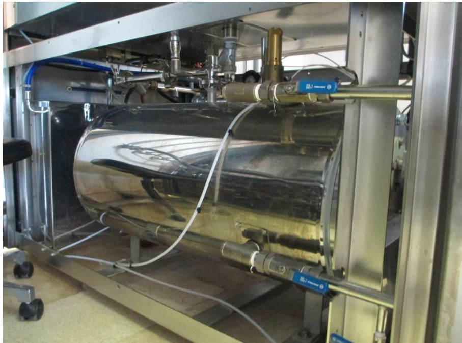
Figura 5.31 – Gerador de Vapor.
