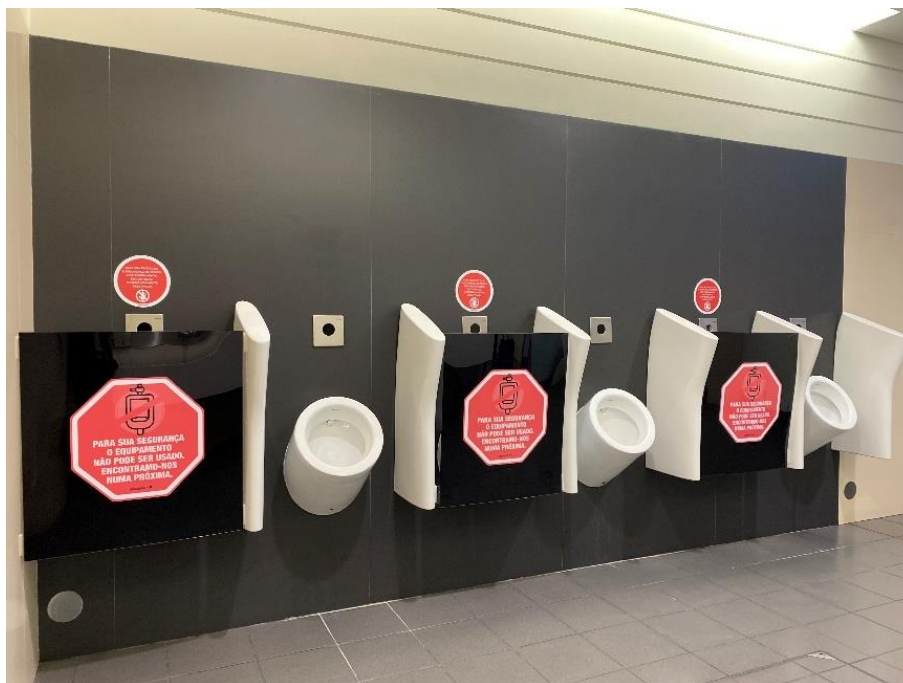
Figura 56 - Imagem do autor - Barreira de Sinalização Centro Comercial Amadora;
