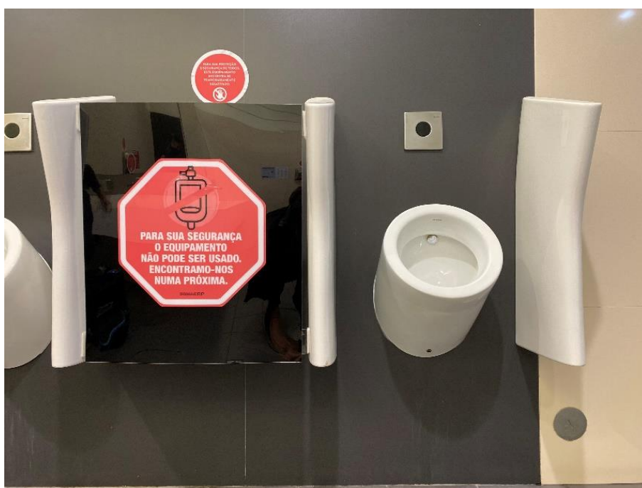
Figura 57 - Imagem do autor - Barreira de sinalização Centro Comercial Amadora;
