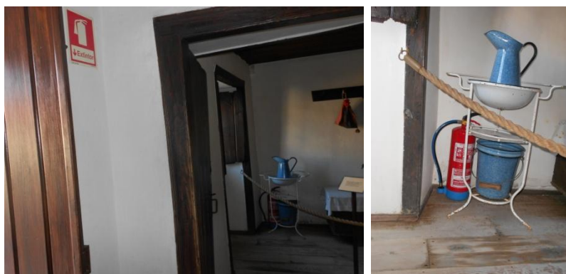
Figura 87 – Localização do extintor e respetiva placa de sinalização
