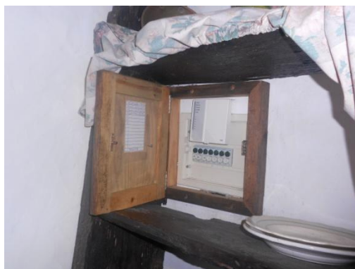
Figura 85 – Instalação elétrica existente (quadro elétrico)
