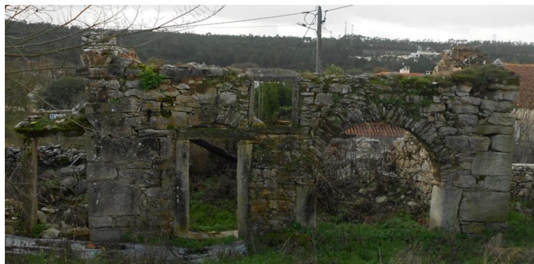
Figura 23 – Casa em ruínas com entrada para palheiro ou estábulo em forma de arco
