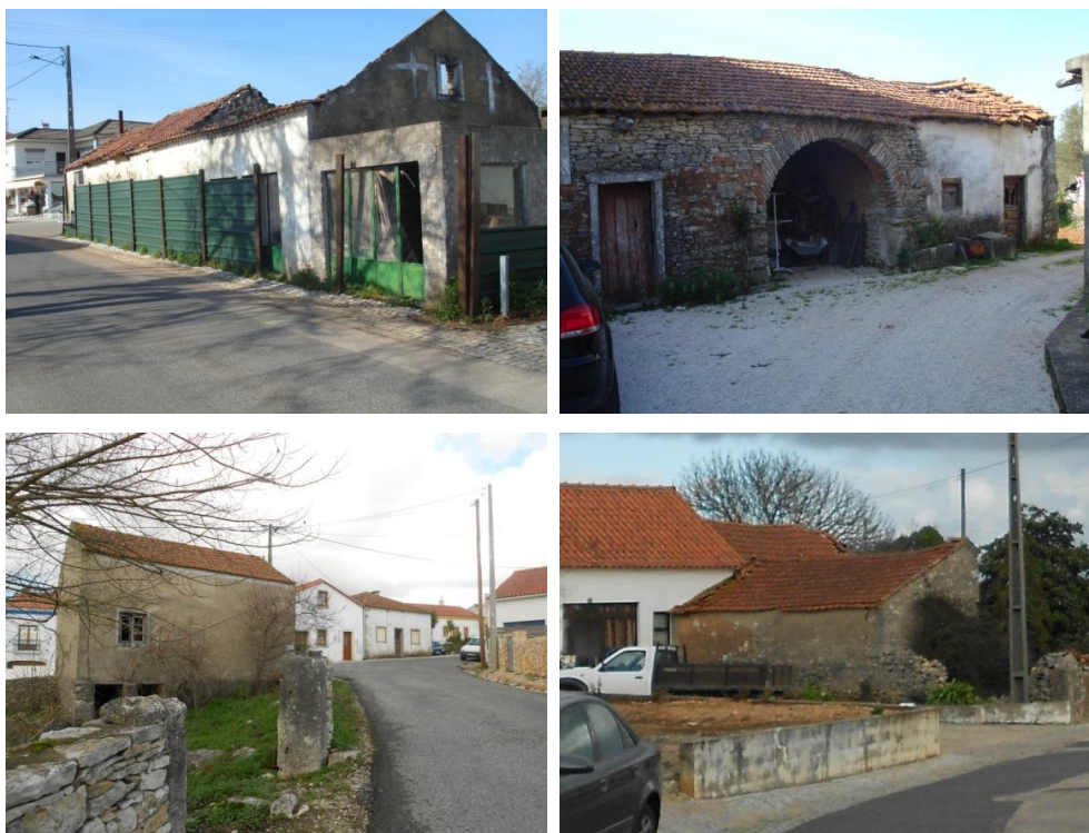
Figura 96 – Casas do núcleo de Aljustrel em mau estado de conservação/abandonadas
