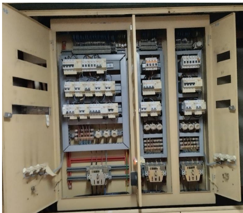
Figura 4.14 – Quadro elétrico antigo existente no serviço de psiquiatria.
