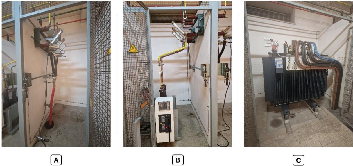
Figura 4.35 – Exemplo de um posto de transformação com as celas: cela proveniente do posto de chegada (A), cela com o disjuntor (SF6) e interruptor-seccionador (B) e o transformador (C).
