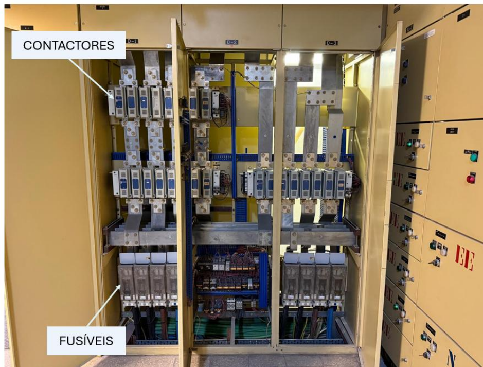
Figura 4.51 – Contactores e fusíveis de um QGBT.
