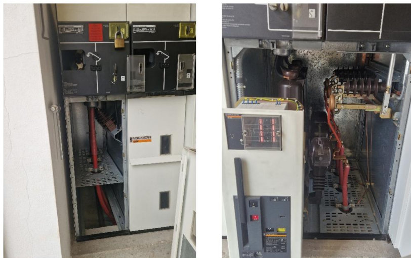
Figura 4.36 – Distribuição de média tensão – solução modular da gama SM6.
