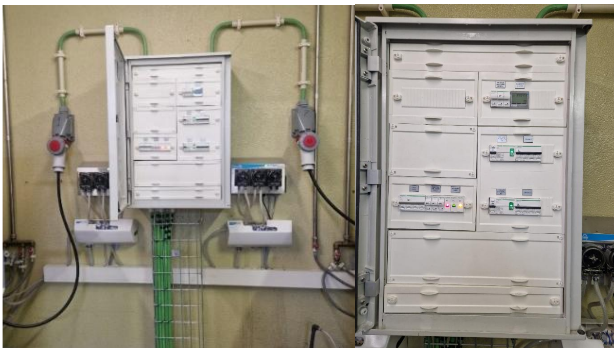
Figura 4.19 – Quadro elétrico destinado à alimentação de duas máquinas de lavagem industriais.
