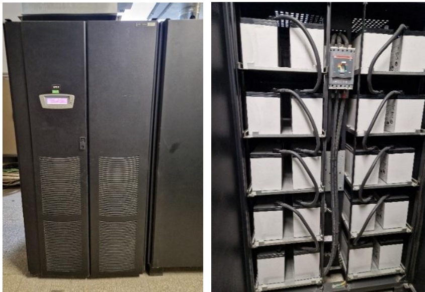
Figura 4.71 – UPS com um display e as respetivas baterias.
