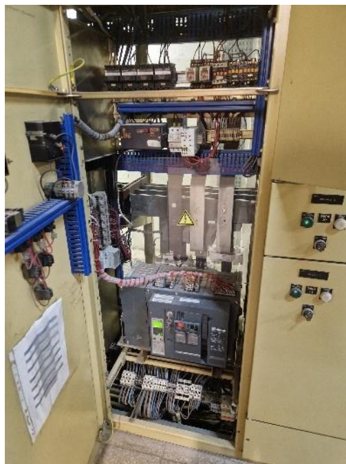
Figura 4.49 – Disjuntor geral de uma secção do QGBT.
