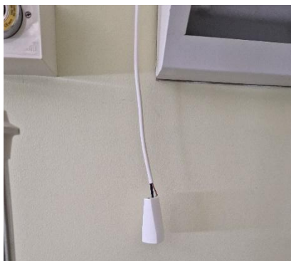
Figura 4.55 – Botão de chamada do utente, localizado no quarto, próximo da cama.
