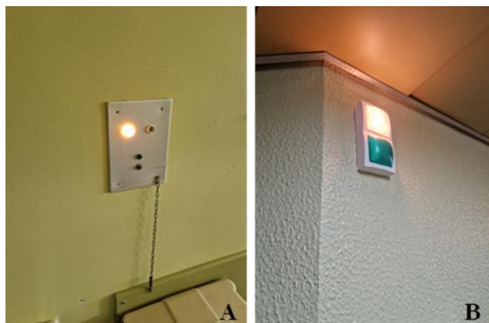
Figura 4.57 – Sinalização quando o botão de chamada é acionado pelo utente. A: Painel de chamada no quarto; B: Sinalização à porta do quarto.
