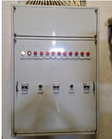
Figura 4.32 – Quadro de encravamentos.
