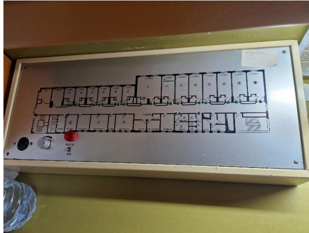
Figura 4.53 – Painel de controlo localizado no posto de enfermagem.
