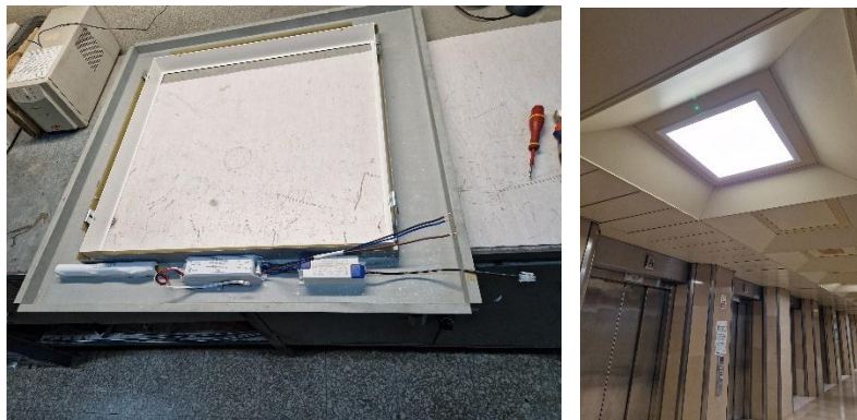
Figura 4.45 – Sistema de alimentação autónoma para iluminação LED.
