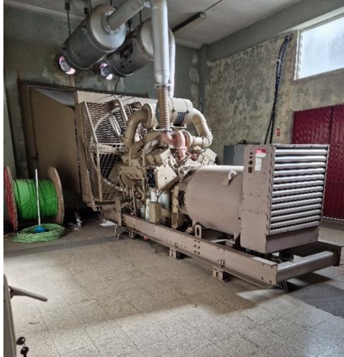
Figura 2.1 – Gerador de um dos postos de transformação.
