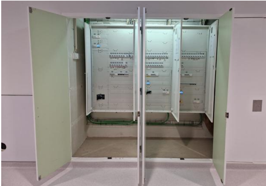
Figura 4.21 – Quadro elétrico da nova urgência.
