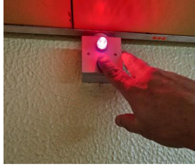
Figura 4.38 – Teste aos sinalizadores dos registos de corta-fogo.
