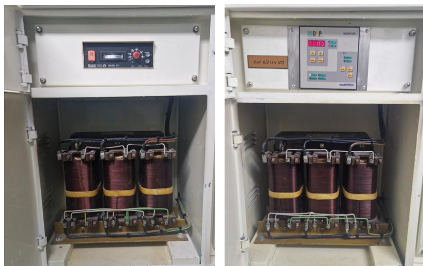
Figura 4.77 – Monitor de defeito e fugas da instalação (monitores de isolamento e do transformador).
