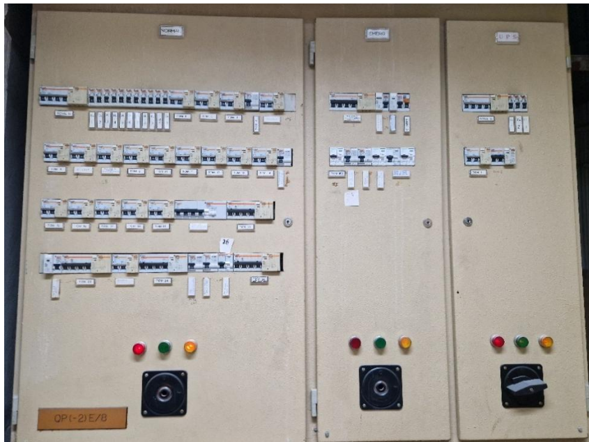
Figura 4.2 – Quadro elétrico existente no Serviço de Farmácia Hospitalar.
