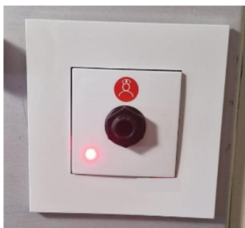
Figura 4.63 – Painel de ligação de pera de chamada em alarme – ficha jack não está colocada.
