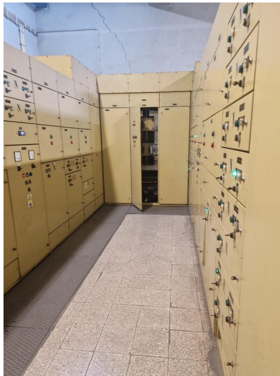
Figura 4.47 – Quadro geral de baixa tensão (QGBT).
