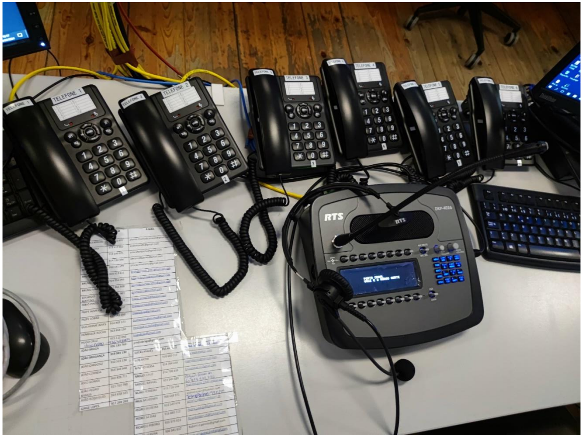
Figura 81. Telefones e intercom
