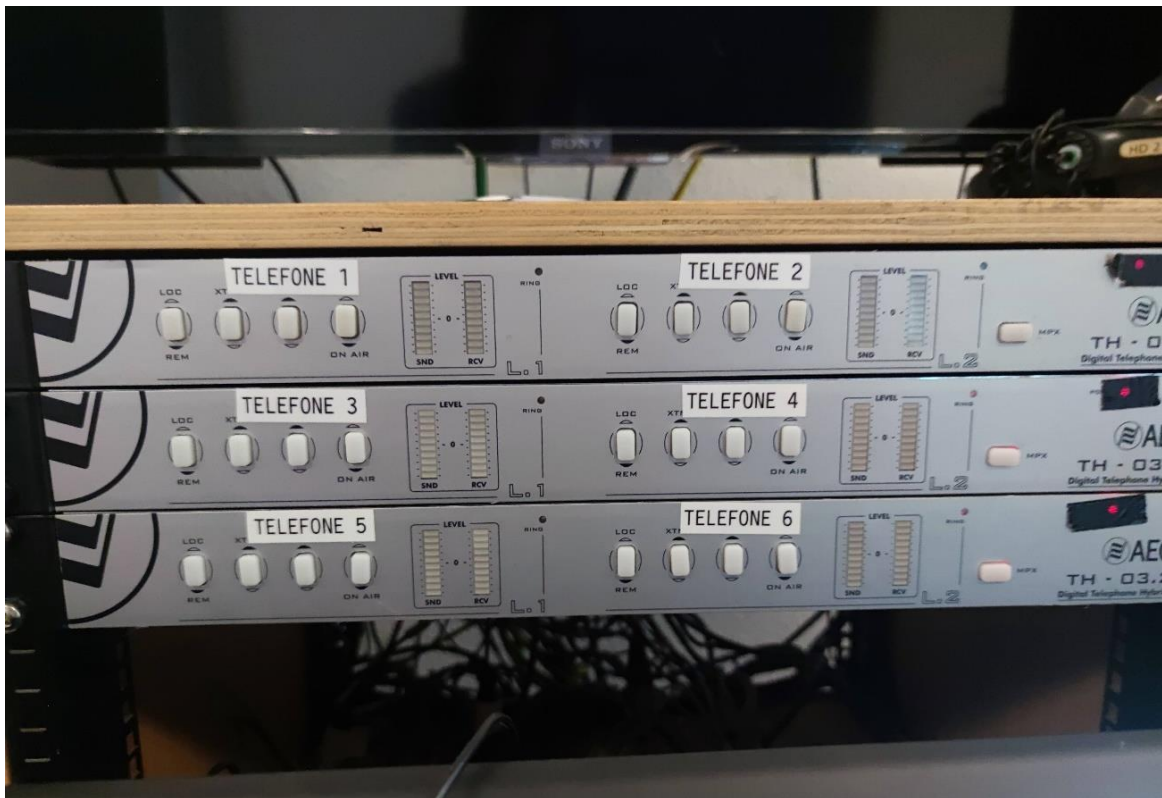
Figura 82. Aparelhos que prendem as chamadas dos telefones
