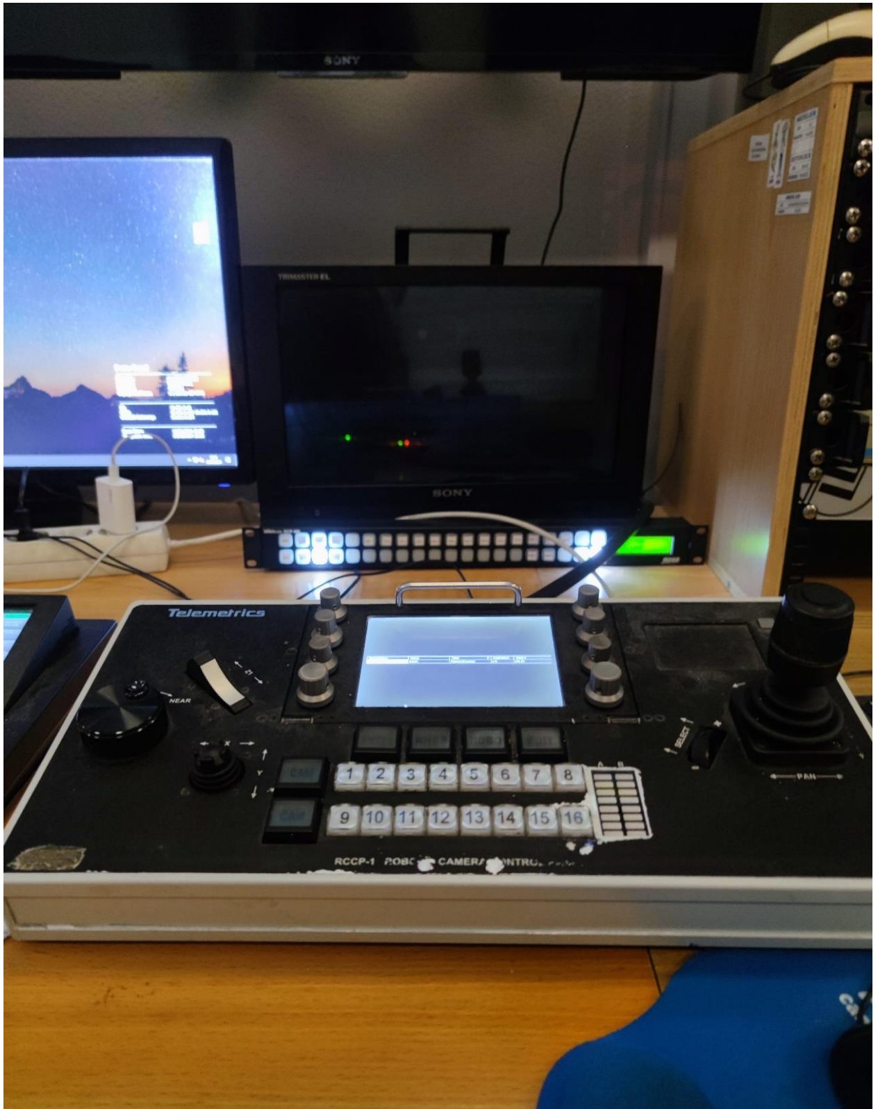
Figura 85. Telefones e intercom
