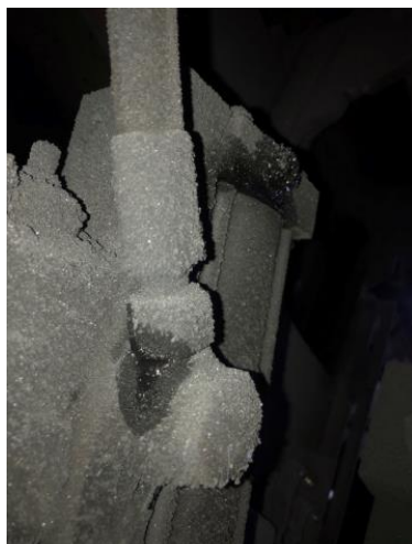
Fuga pelo acessório da mangueira
