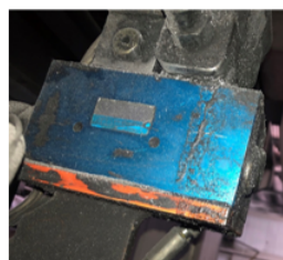
Fuga pela válvula
