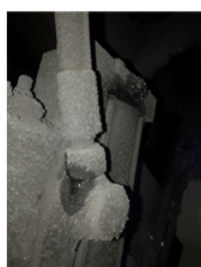
Fuga pelo acessório da mangueira
