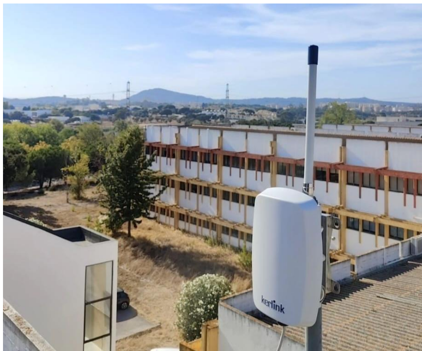
Figura 47: Local de instalação da gateway .
