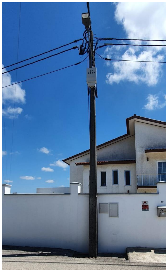
Figura 2.17 – Caixa de proteção de redes aéreas em Baixa Tensão.
