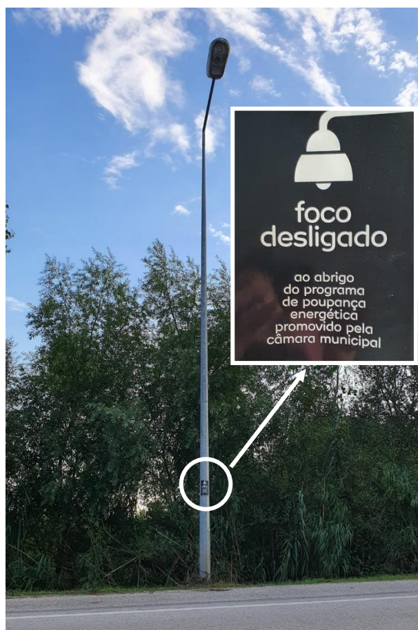
Figura 5.1 – Coluna de Iluminação Pública com sinalização de foco desligado.
