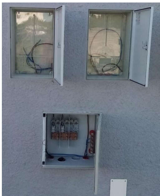
Figura 5.23 – Caixa de distribuição e respectivas caixas de contador.
