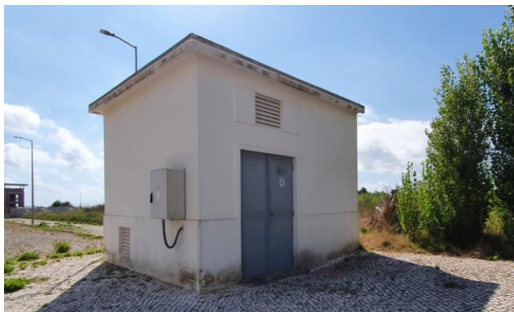
Figura 2.10 – Posto de Transformação de Distribuição em Cabine Baixa.
