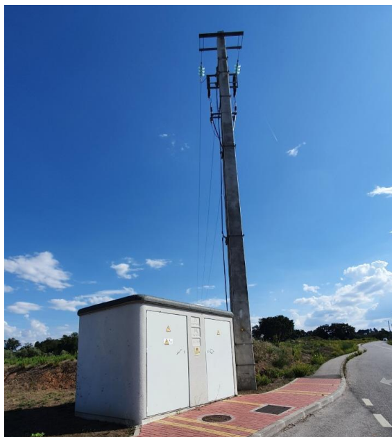
Figura 2.11 – Posto de Transformação de Distribuição do tipo pré-fabricado.
