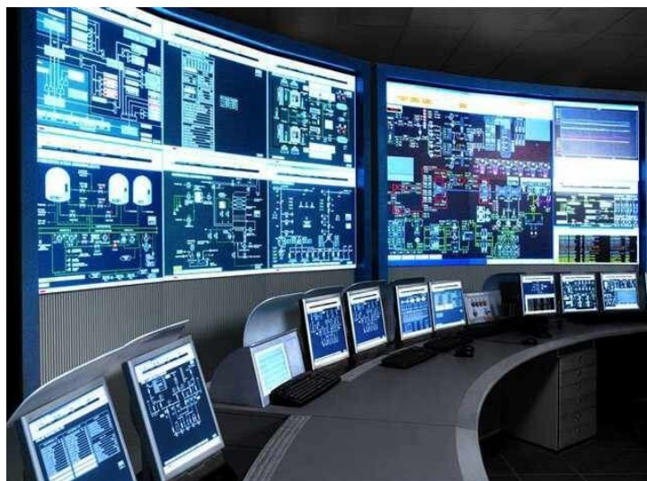
Figura 11 – Sala de Controlo do Sistema SCADA 10
